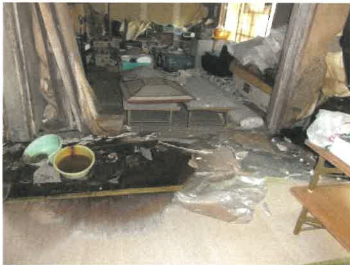
物件2-1建物ホテル棟1階(但し、建物間取図上は2階)北西側談話室及び食堂の状況
