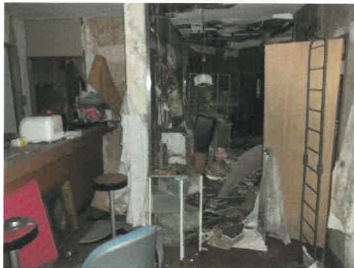
物件21建物ホテル棟1階（但し、建物間取図上は2階）北西側カウンター前から玄関前への廊下の状況
