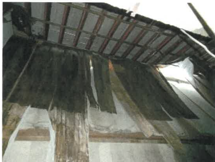
物件 2 1 建物ホテル棟 2 階（但し、建物間取図上は 3 階）廊下部分天井の損傷状況
