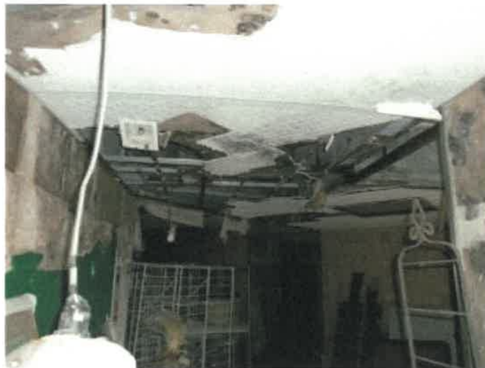
物件21建物ホテル棟1階（但し，建物間取図上は2階）の正面玄関前の天井の損傷状況
