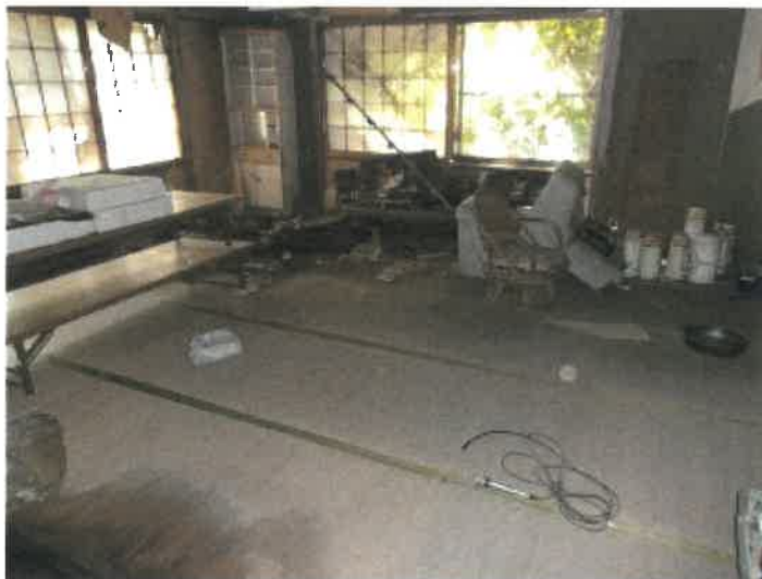
物件 2 1 建物ホテル棟 1 階（但し，建物間取図上は 2 階）北西側談話室及び食堂の状況
