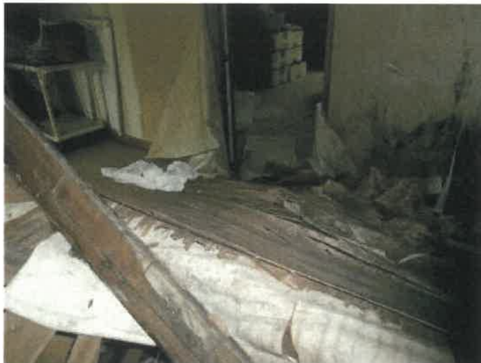
物件21建物ホテル棟2階（但し、建物間取図上は3階）の階段前北西側和室の出入口付近の状況
