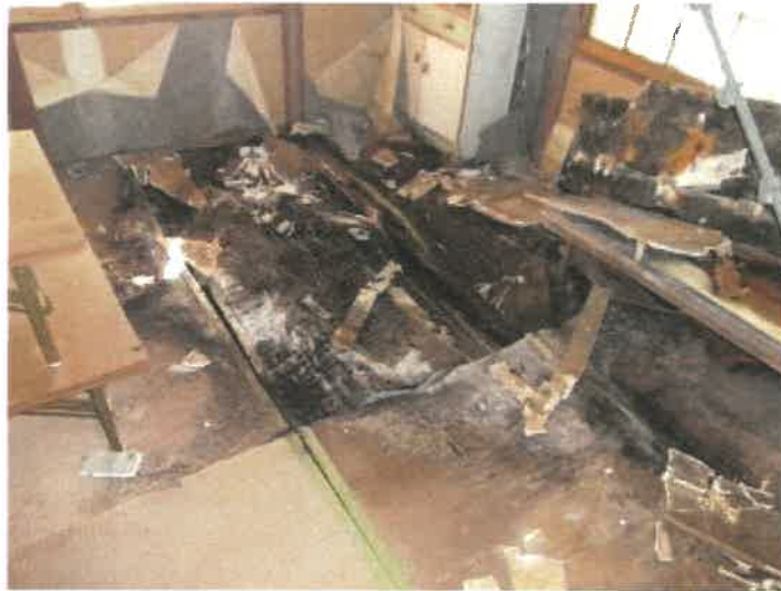
物件2-1建物ホテル棟1階(但し、建物間取図上は2階)北西側食堂の西端付近の損傷状況
