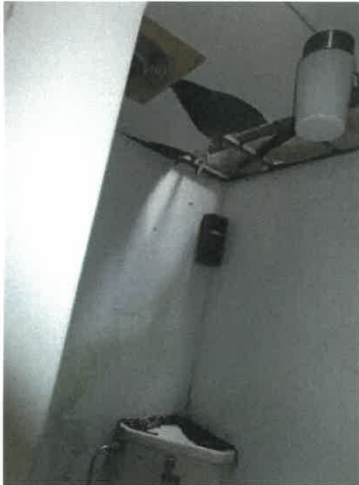
物件21建物の浴室棟2階北西側風呂場の更衣室のトイレ天井の損傷状況
