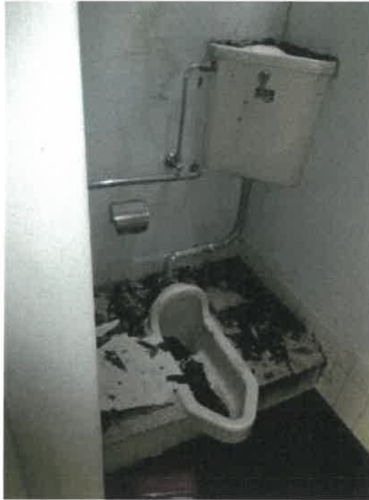
物件21建物の浴室棟2階北西側風呂場の更衣室のトイレの状況
