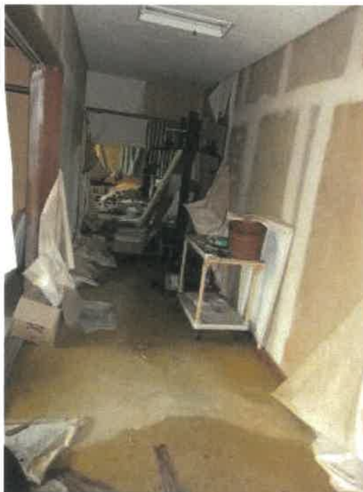
物件21建物ホテル棟2階（但し、建物間取図上は3階）廊下部分の損傷状況
