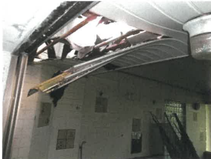
物件2-1 建物の浴室棟2階南東側風呂場の更衣室から浴室への出入口天井の損傷状況
