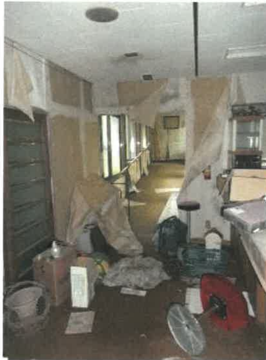
物件21建物ホテル棟1階（但し、建物間取図上は2階）北西側の中央付近北東側浴室棟 2階への廊下付近の状況
