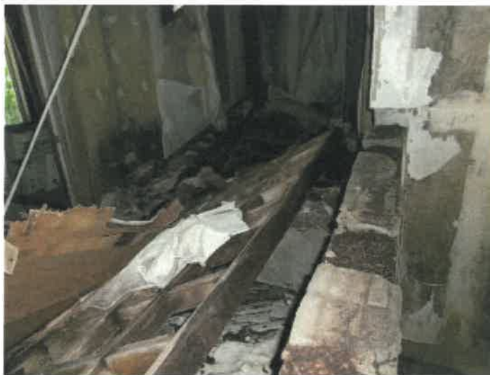
物件21建物ホテル棟2階（但し、建物間取図上は3階）廊下部分の損傷状況
