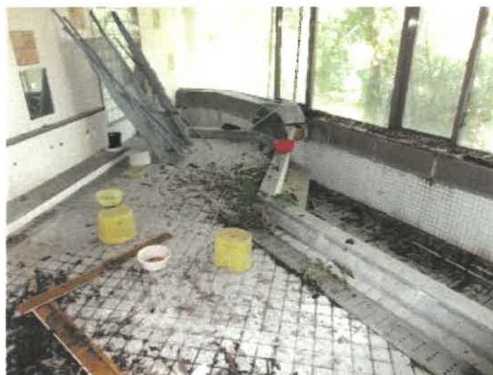
物件2-1 建物の浴室棟2階南東側風呂場の浴室の損傷状況
