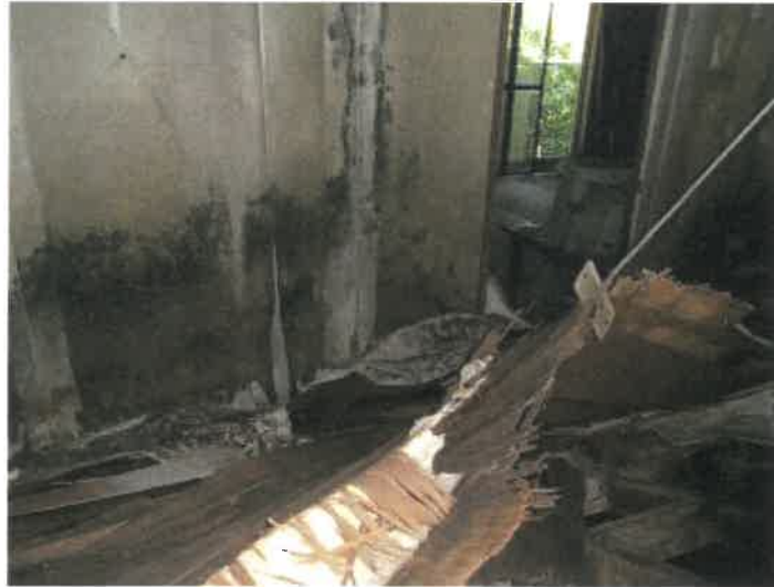
物件21建物ホテル棟2階（但し、建物間取図上は3階）の階段前南東側和室の出入口付近の状況
