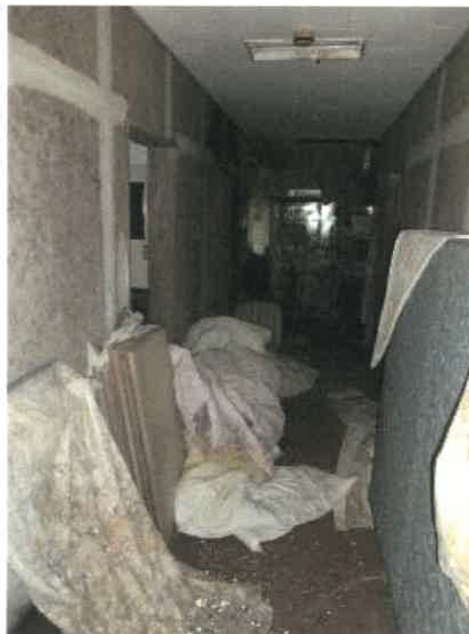
物件 2 1 建物ホテル棟 1 階（但し、建物間取図上は 2 階）南側廊下の状況
