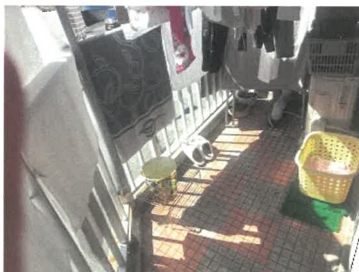
物件7建物の2階ベランダの状況
