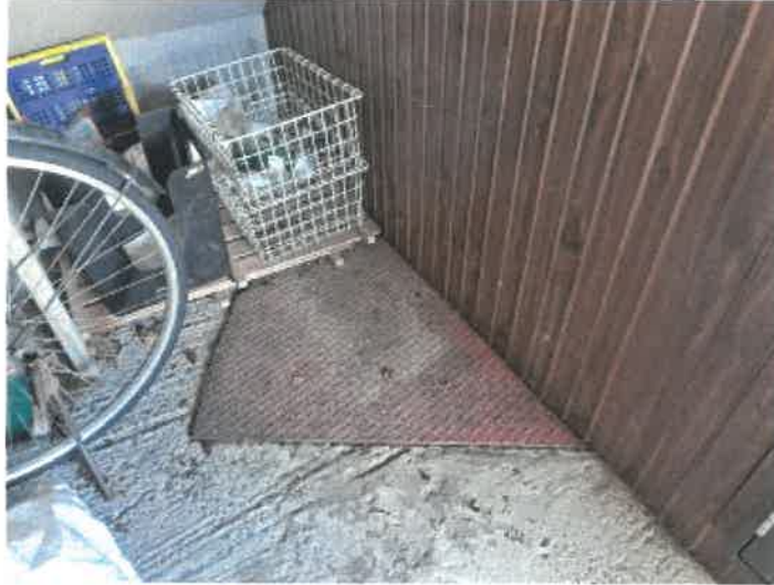
物件7建物1階車庫部分の床下に水が溜まっているとされる箇所の東端の蓋（鉄板）の状況
