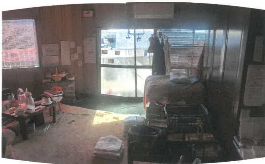
物件7建物の2階洋室南側の状況
