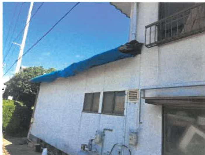
物件7建物西側北寄り部分の屋根の損傷（ブルーシートを被せて応急処理）状況
