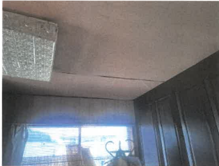
物件7建物の2階洋室西側天井の雨漏りの状況
