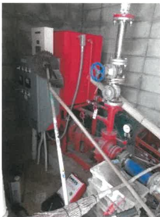
西側機械室西端の消火ポンプ室の状況
