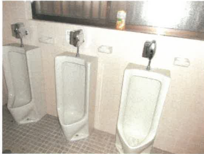
物件 8 建物部分 1 階男子トイレの状況
