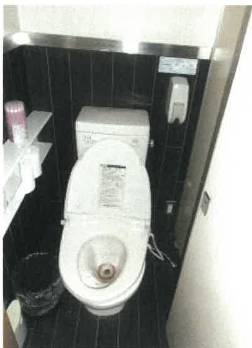
物件 8 建物部分 2 階東側女子トイレの状況
