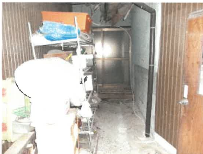
物件 8 建物部分の内の居宅部分 1 階 D K の東側通路の状況
