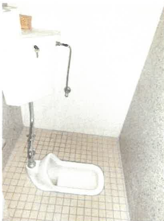
物件 9 建物部分の 2 階南側女子トイレの状況
