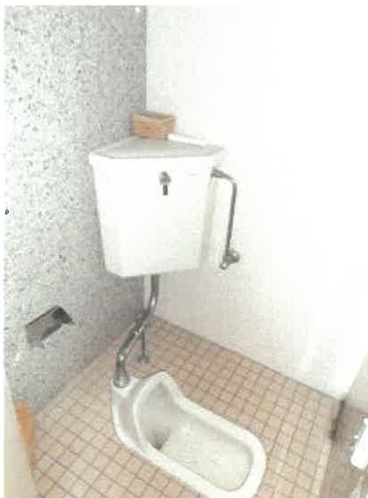
物件9建物部分1階の北側女子トイレの状況
