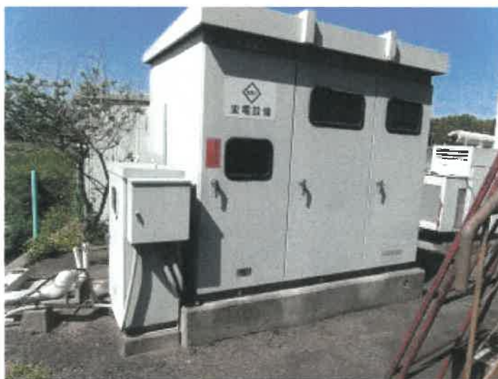
キュービクル（高圧変電設備）の状況
