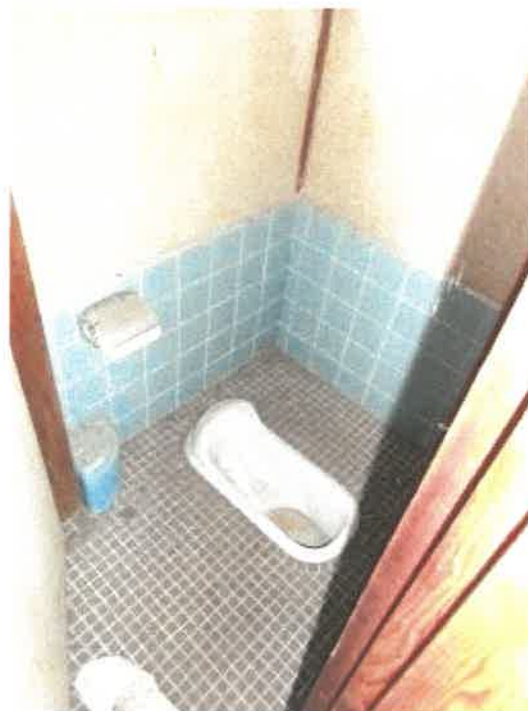
物件 8 建物部分の内の居宅部分 2 階のトイレの状況
