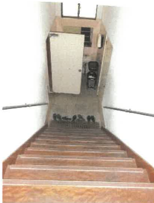
物件 8 建物部分 1 階トイレの階段付近の状況
