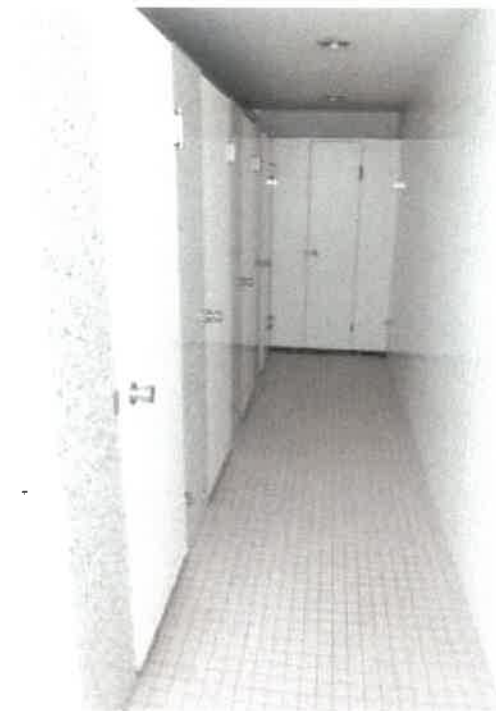
物件 9 建物部分の 2 階南側女子トイレの状況
