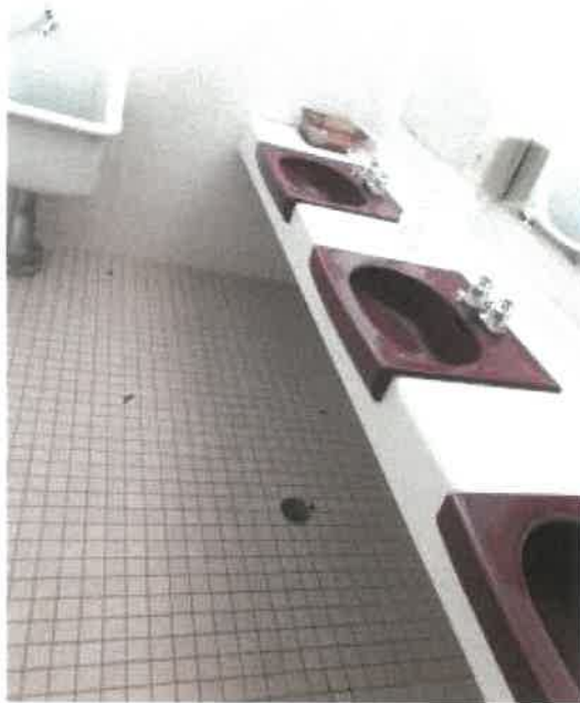
物件 9 建物部分の 2 階南側女子トイレの状況
