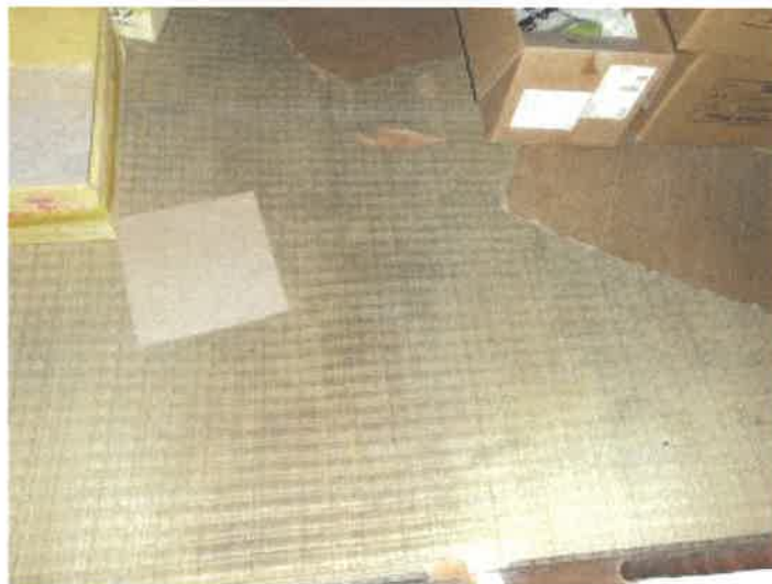
物件 8 建物部分 1 階西端ゾーン居宅DK東側和室のブカブカしている箇所
