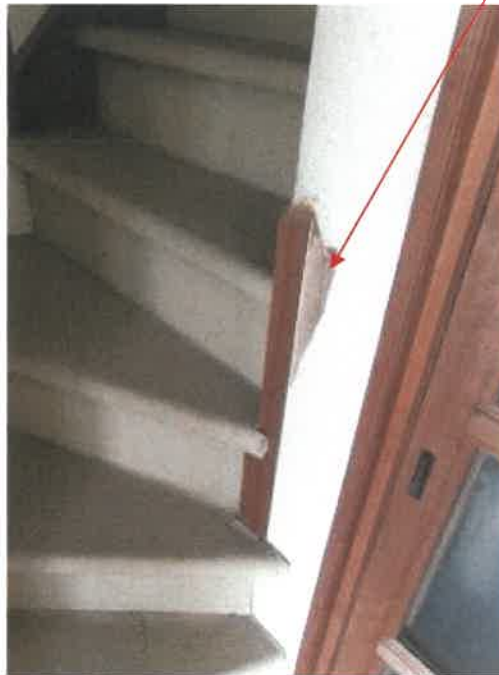
物件8建物部分の内の居宅部分1階階段上がり口付近の状況
