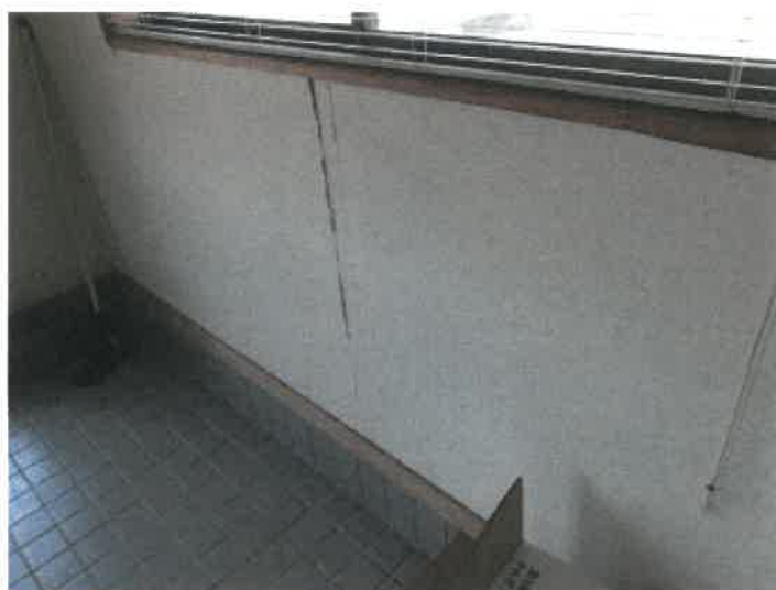
物件 8 建物部分の内の居宅部分 1 階玄関の壁の損傷状況
