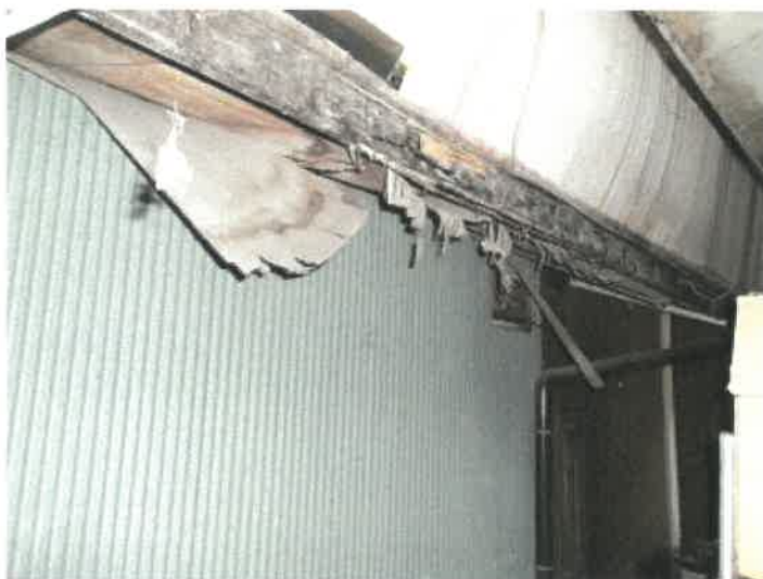
物件 8 建物部分の内の居宅部分 1 階 D K の東側通路の屋根の損傷状況
