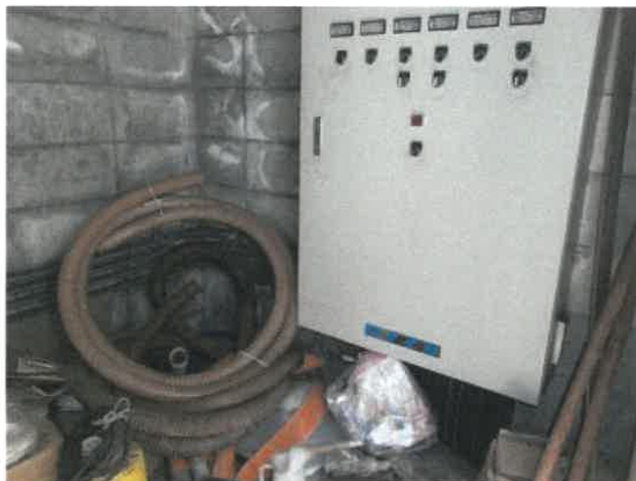
浄化槽機械室内部の状況
