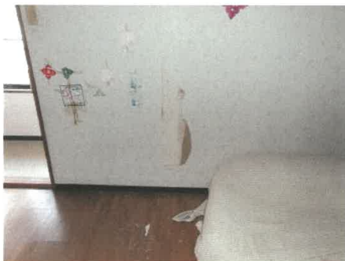
物件8建物部分の内の居宅部分2階東側洋室の北側壁の損傷状況
