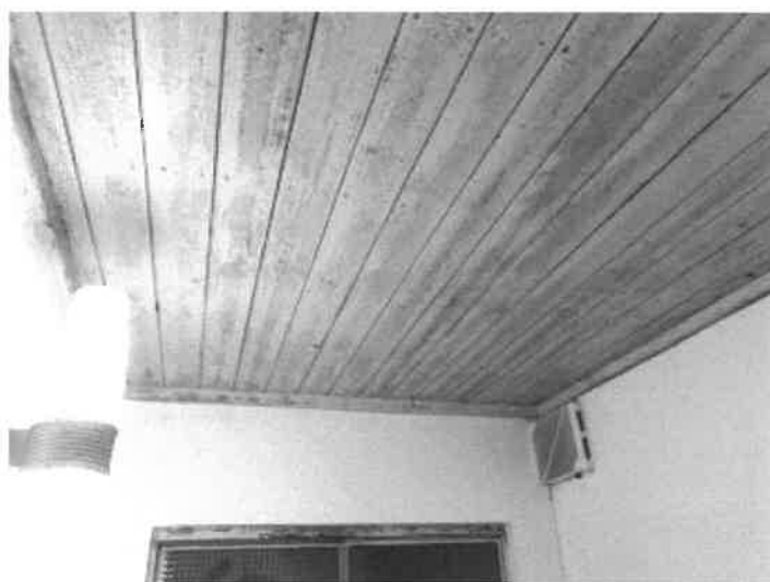
物件8建物部分の内の居宅部分1階浴室天井のカビの状況
