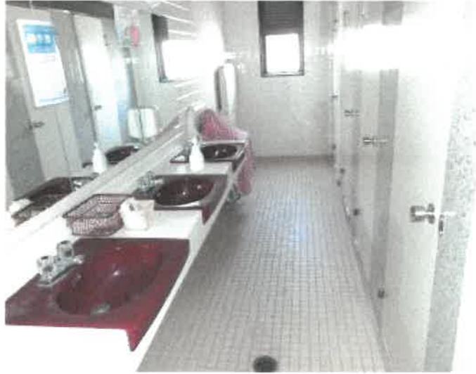
物件 9 建物部分 1 階の北側女子トイレの状況
