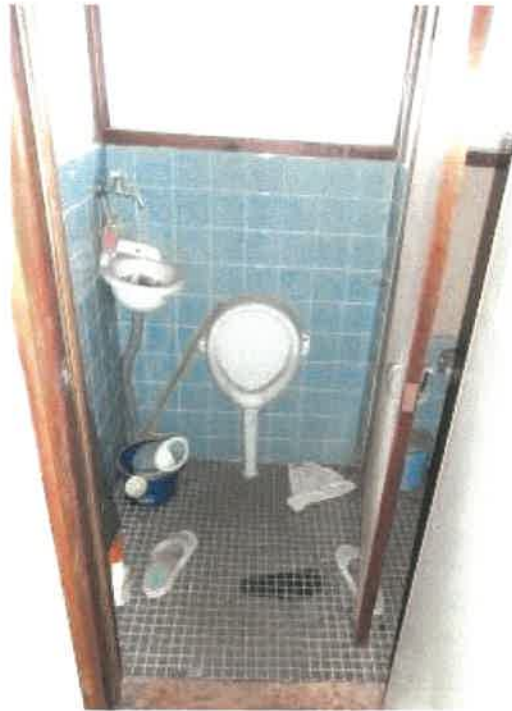
物件 8 建物部分の内の居宅部分 2 階のトイレの状況
