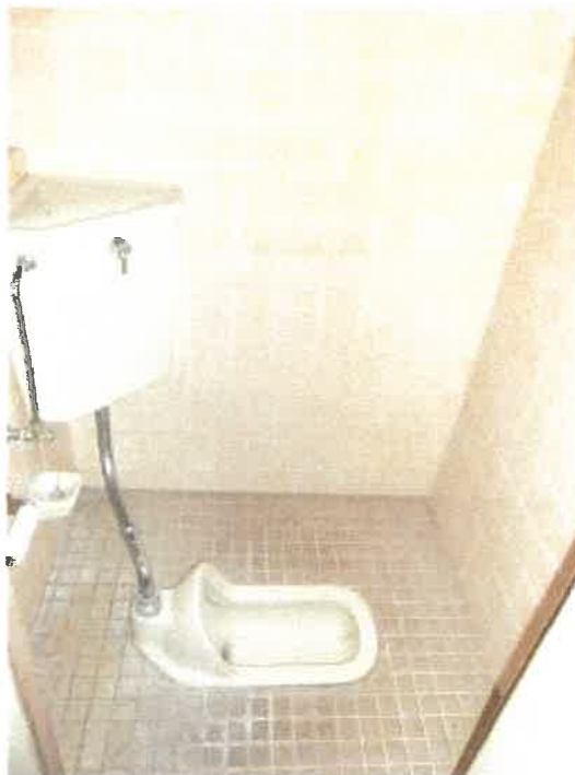
物件 8 建物部分 1 階男子トイレの状況
