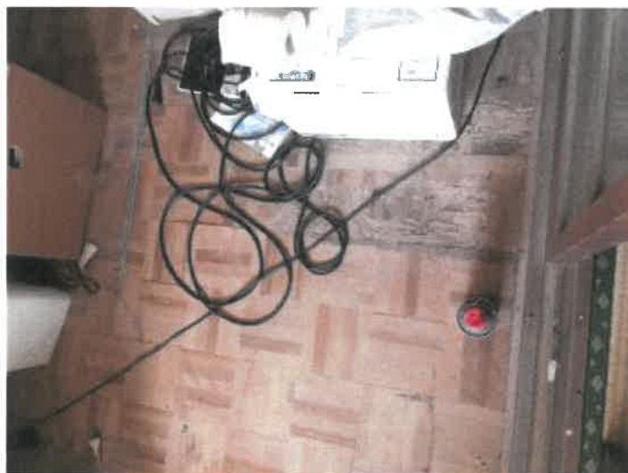
物件 8 建物部分の内の居宅部分 1 階玄関東側洋室の床の損傷状況
