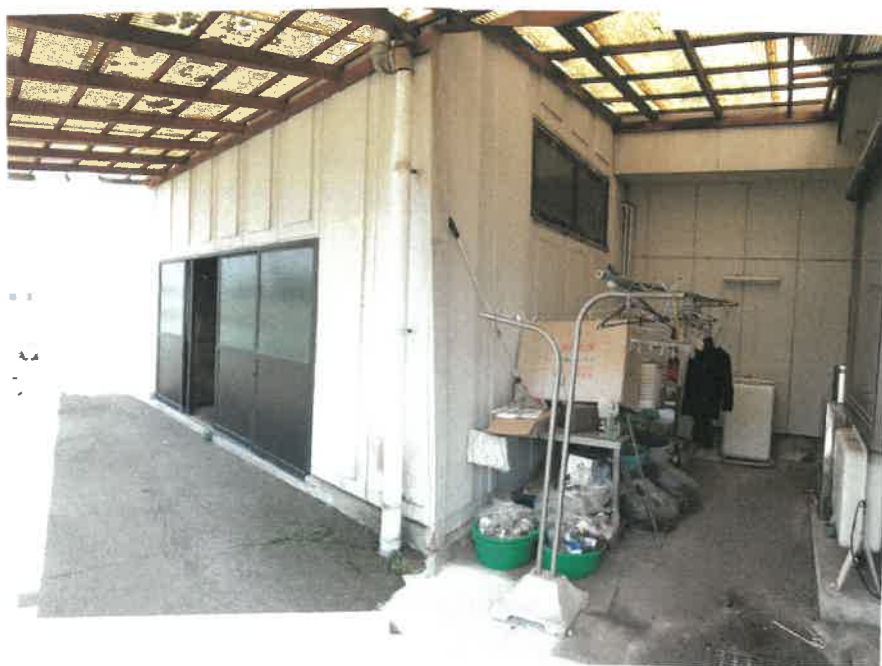
物件 9 建物部分 1 階厨房南西角付近の状況
