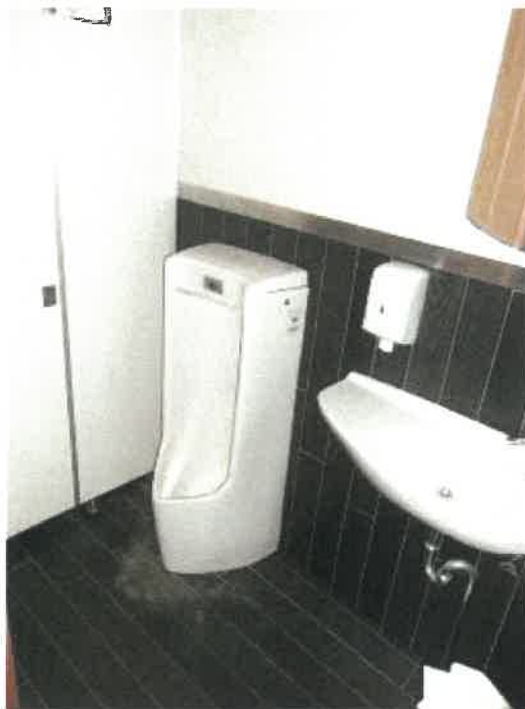
物件 8 建物部分 2 階東側男子トイレの状況
