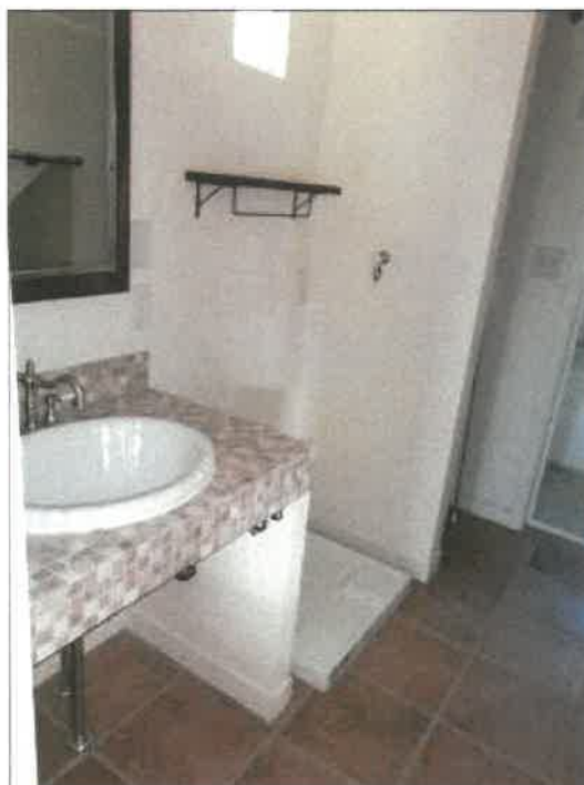
物件3建物の1階洗面脱衣所の状況
