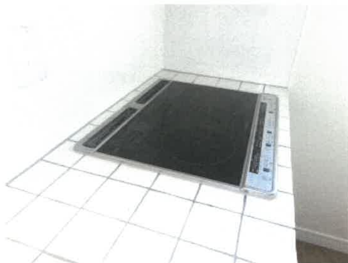
物件3建物の1階キッチンのIHクッキングヒーター設置状況
