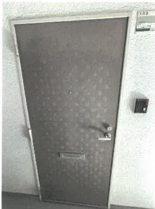
103号室入口ドアの状況
