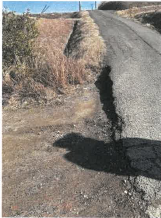
物件1 南東側の道路淵の陥没状況
