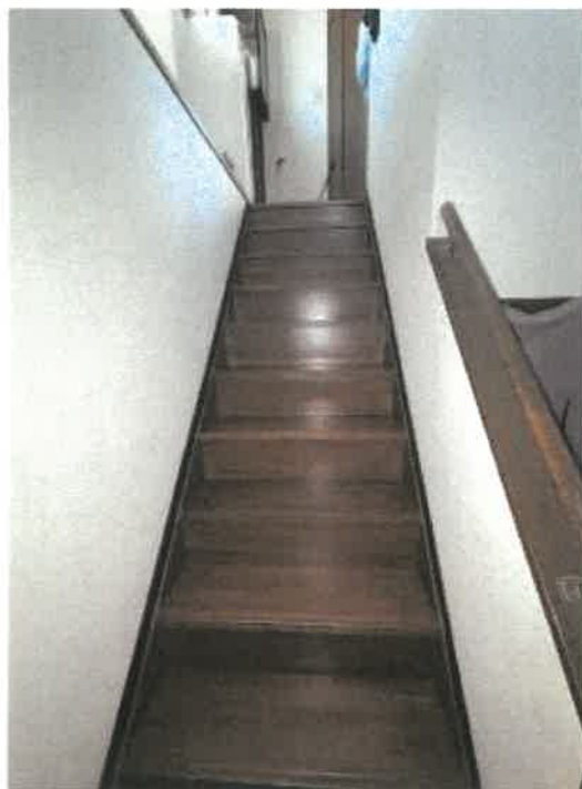
物件2 階段の状況
