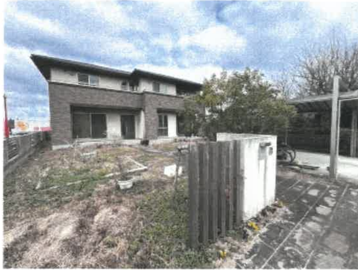
門袖壁付近の状況
