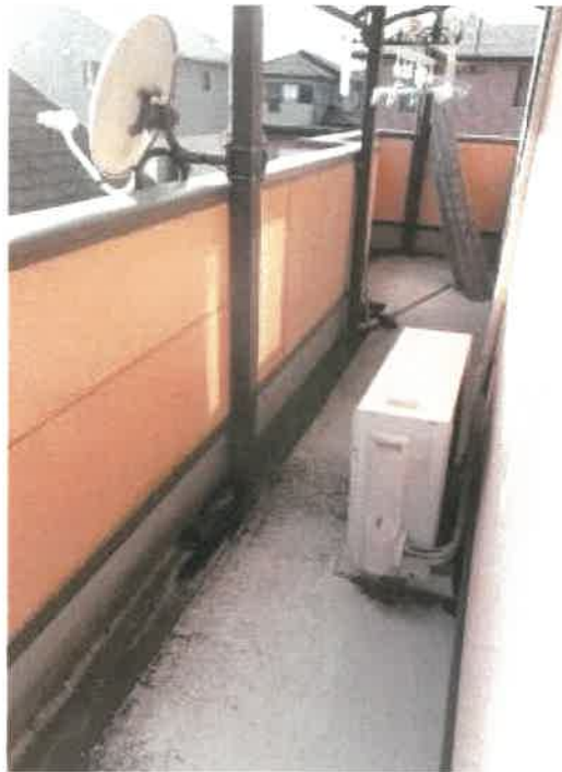
物件1建物2階バルコニーの状況
