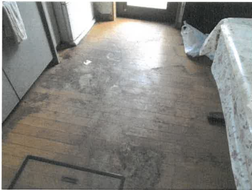
8 物件4建物の台所の床が汚れている状況
