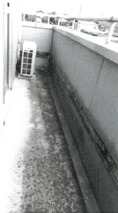
2階バルコニーの状況
