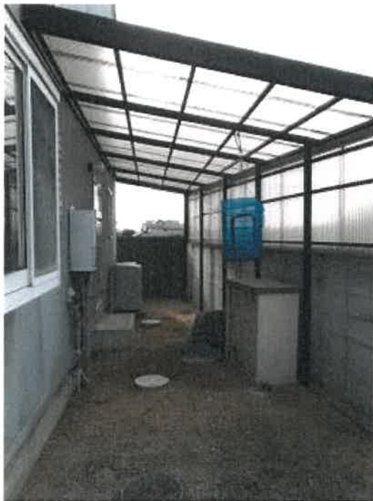
物件1 建物北側下屋の状況
