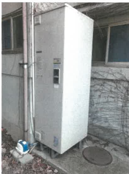
物件2建物浴室外側の電気温水器の状況
