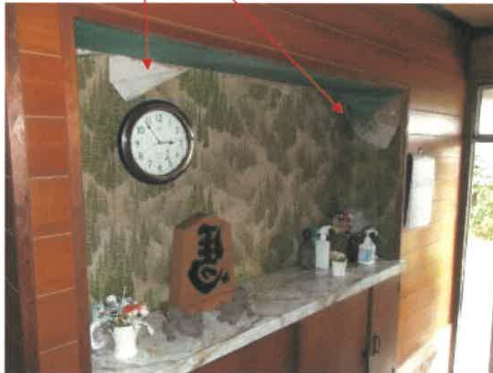
物件2建物玄関付近壁の損傷箇所の状況
