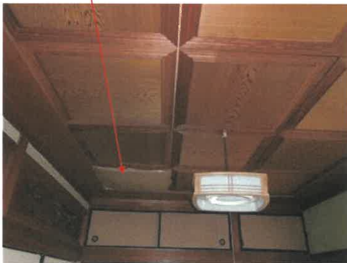
物件 2 建物西側 2 間北側和室天井の損傷状況
