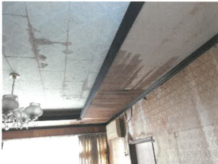
物件 2 建物玄関西側洋室天井の損傷状況
