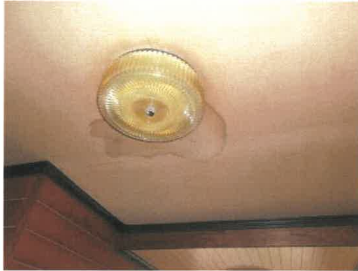
玄関付近天井の雨漏り痕の状況
