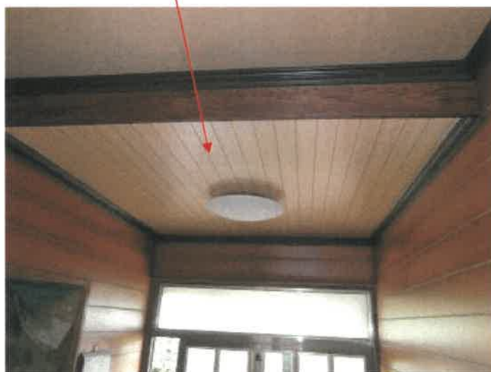
物件2建物玄関付近天井の状況
