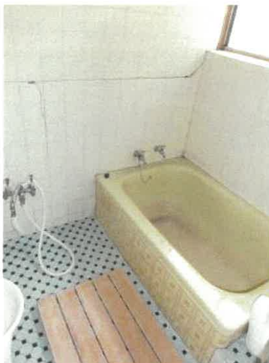
物件2建物浴室の状況
