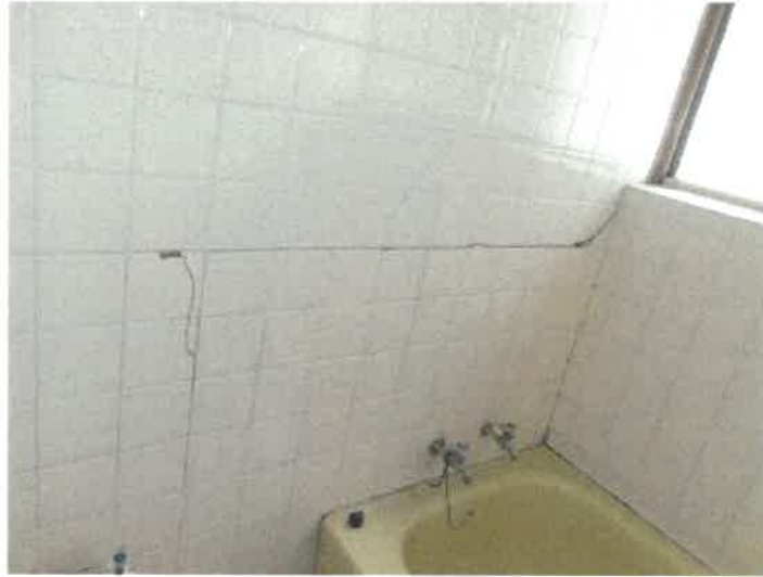
物件 2 建物浴室のタイルの損傷状況
