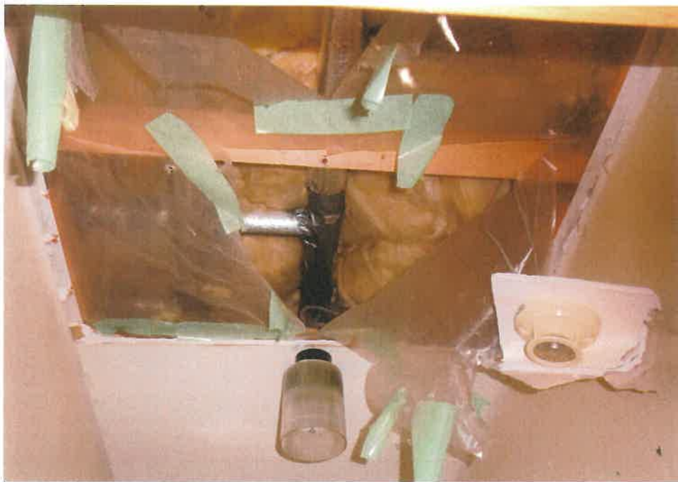
(39) 2階 201号室 トイレの天井の損傷
