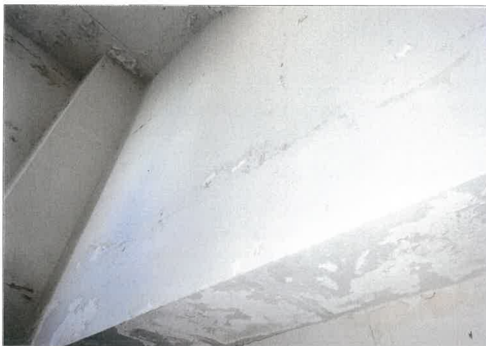
(11) 2階階段付近の壁の損傷
