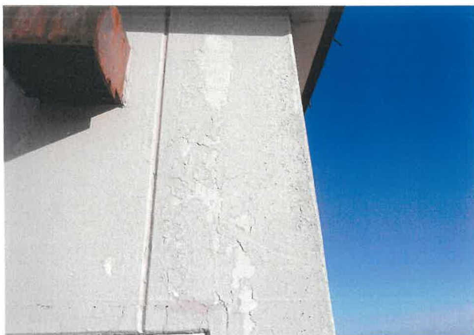
(26) 6階 機械室の外壁の損傷
