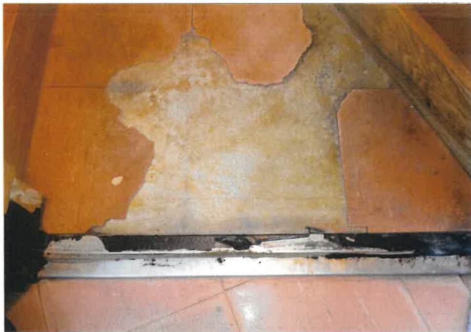
(70) 5階 502号室 玄関床のPタイルの損傷
