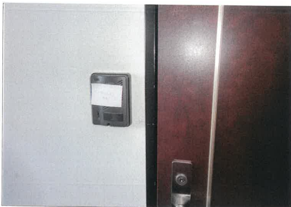
(72) 5階 502号室 玄関チャイムが使用出来ない状況
