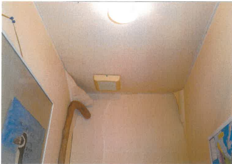
(47) 3階 301号室 トイレの天井クロスの剥離
