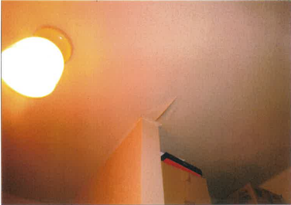
(69) 5階 502号室 ホールの天井クロスの剥離
