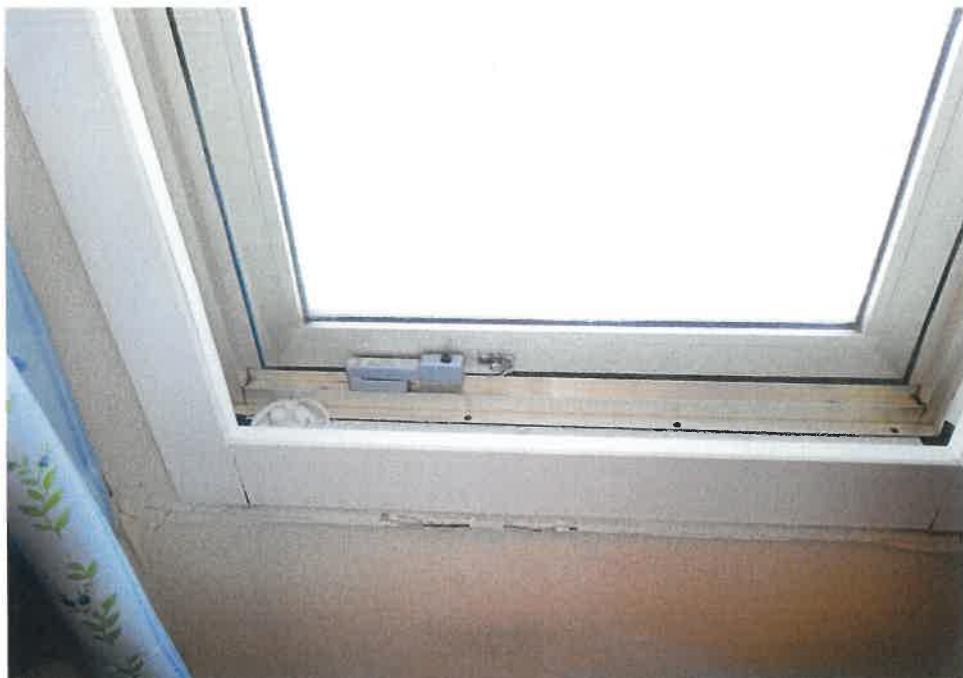
(42) 2階 202号室 居間の窓付近の結露
