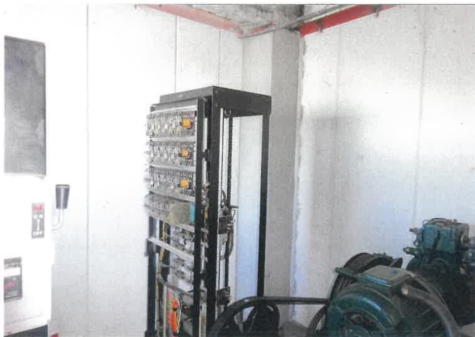
(25) 6階 エレベーター機械室内
