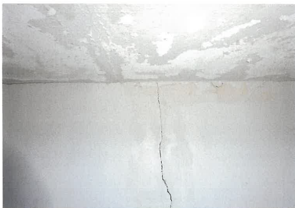
(12) 2階階段付近の壁の損傷
