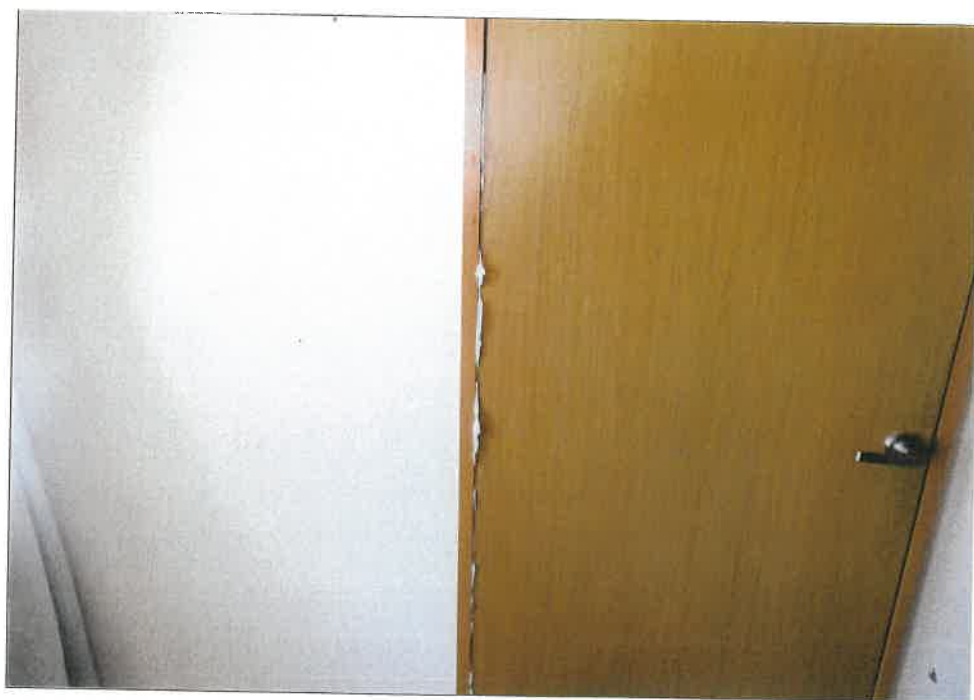
(65) 5階 502号室 洋室2のドアの隙間に紙が挟まっている状況
