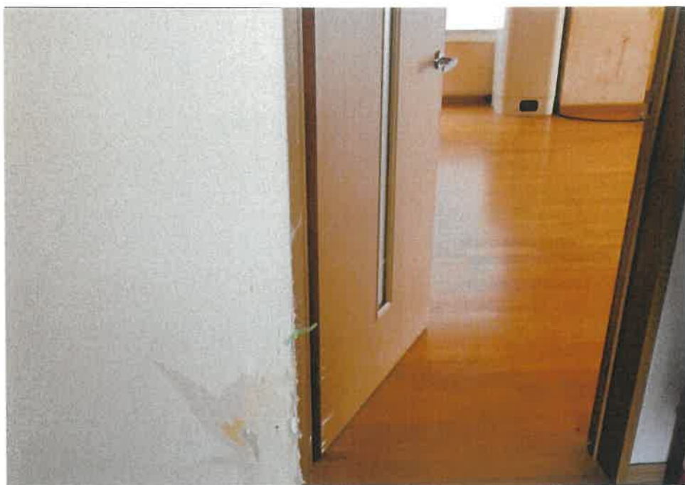
(40) 2階 201号室 ホールの壁の引っ掻き傷
