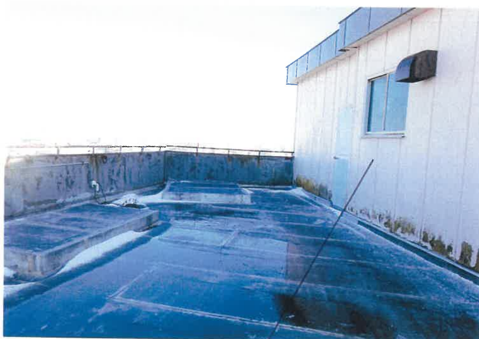
(30) 屋上(防水シートの劣化等)
