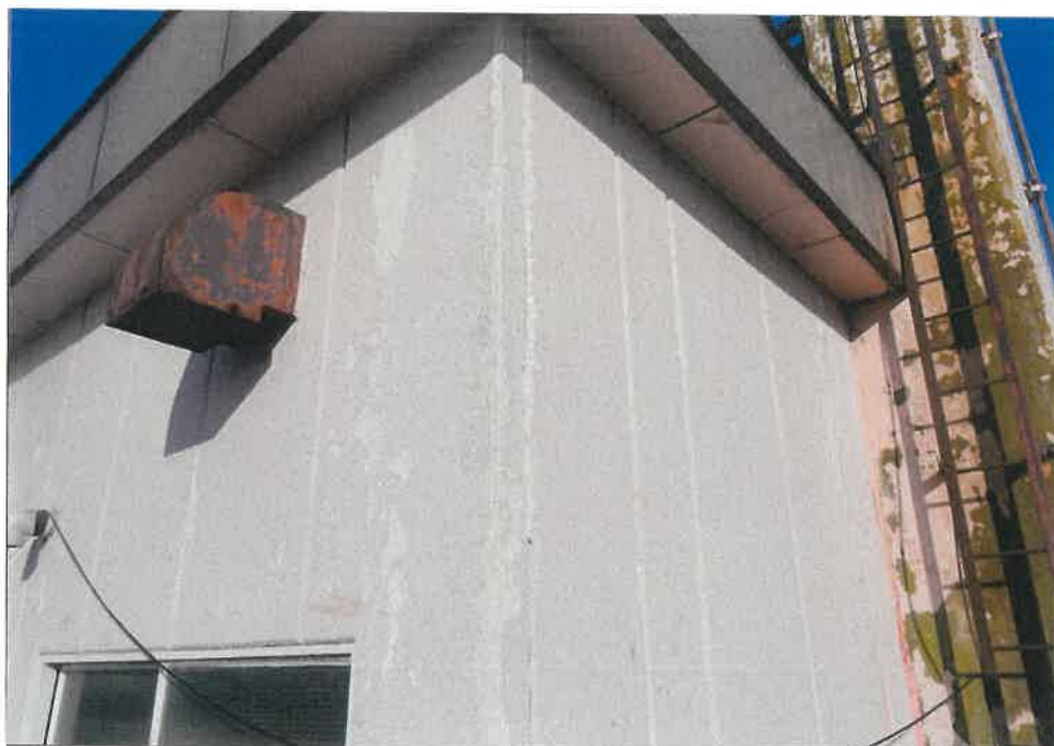
(28) 6階 機械室の外壁の損傷、腐食
