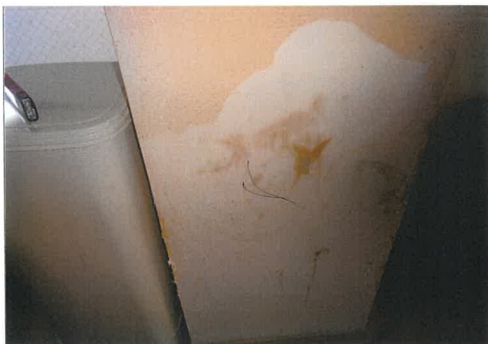
(32) 2階 201号室 居間の壁クロスの剥離
