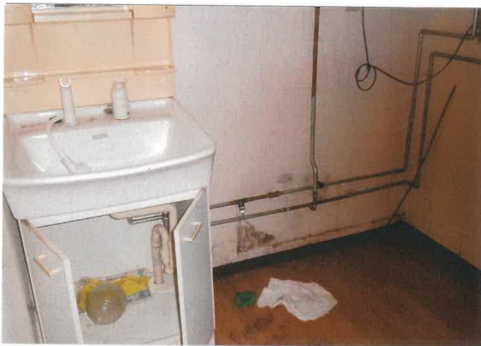
(37) 2階 201号室 洗面台付近の壁、床の汚損
