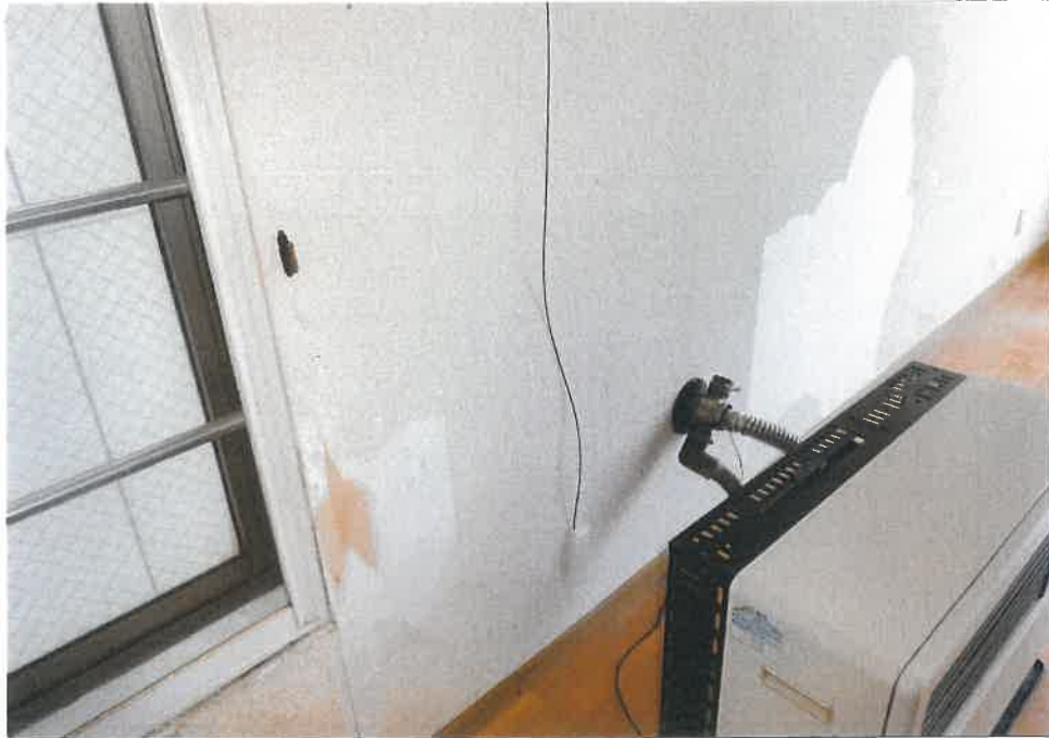
(33) 2階 201号室 居間の壁クロスの剥離
