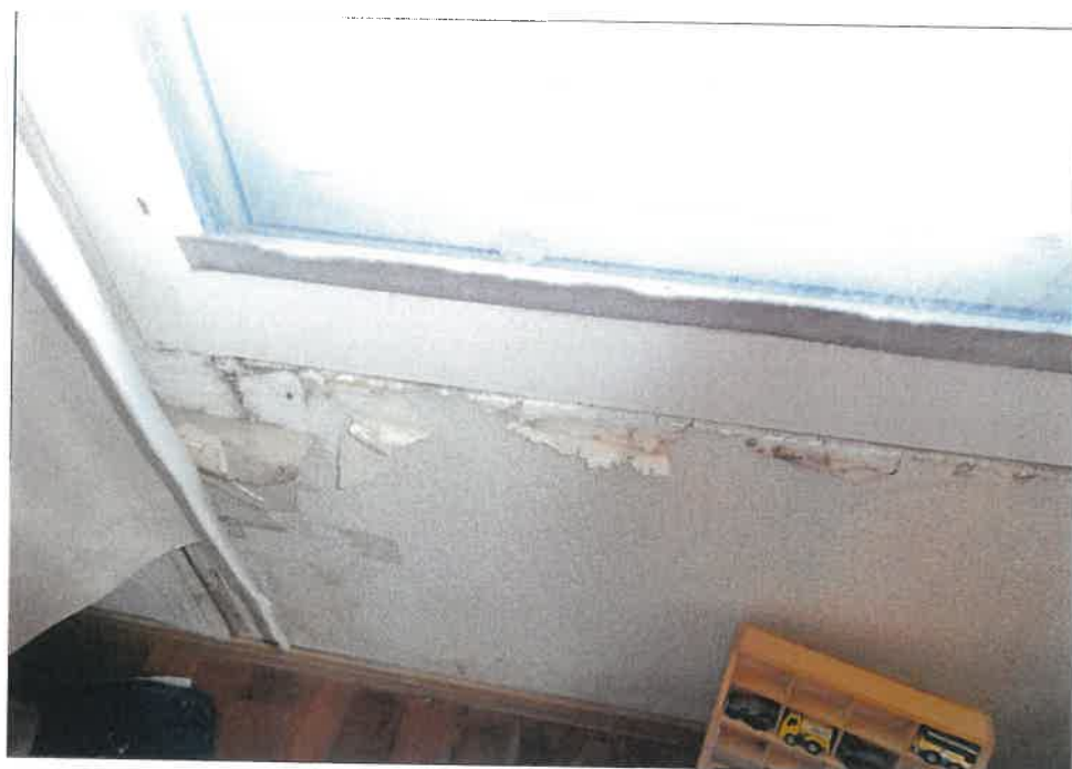
(66) 5階 502号室 洋室2の壁クロスの剥離
