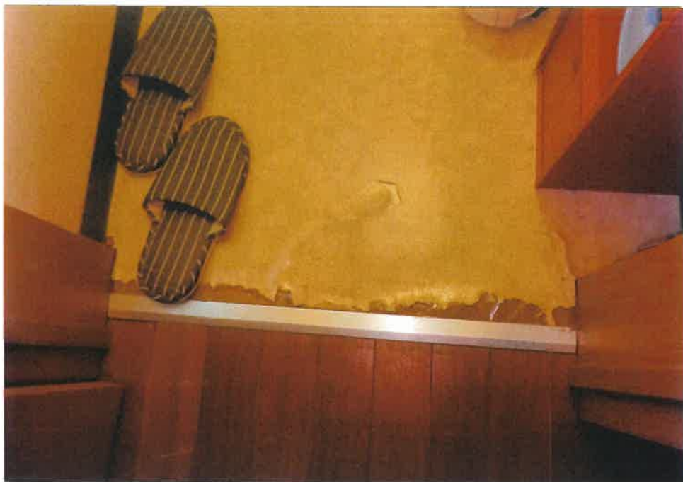
(68) 5階 502号室 トイレの床材の剥離
