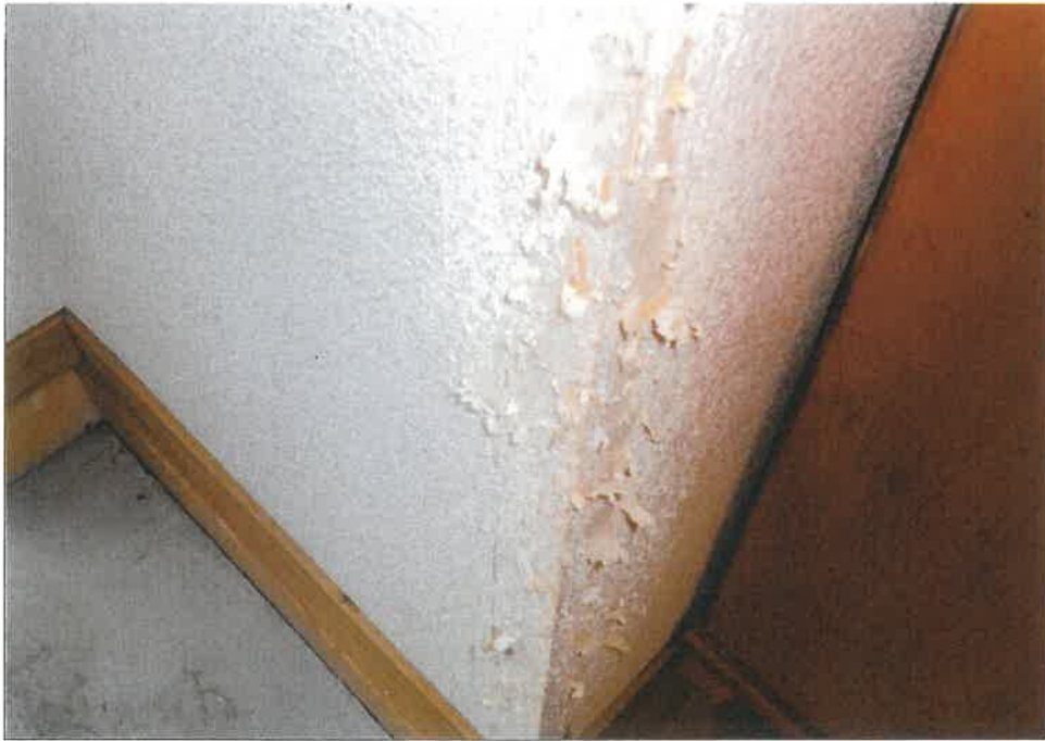
(41) 2階 201号室 ホールの壁の引っ掻き傷等
