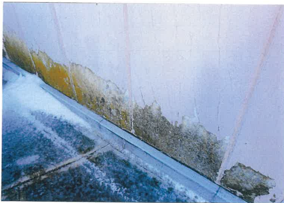
(27) 6階 機械室の外壁の損傷
