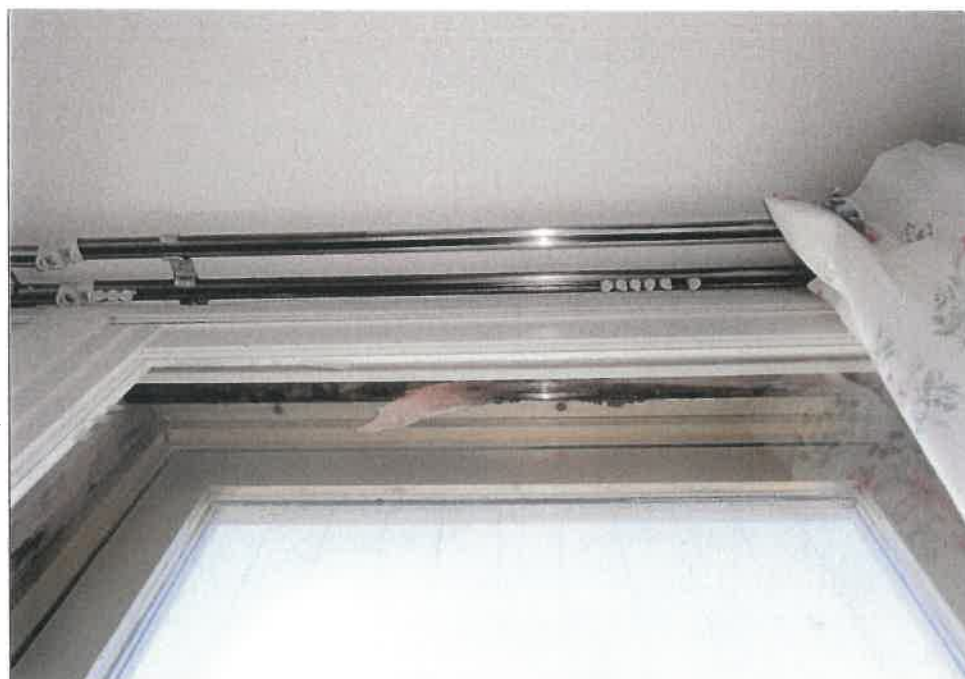
(56) 4階 402号室 洋室2の窓枠の建材の損傷、剥離
