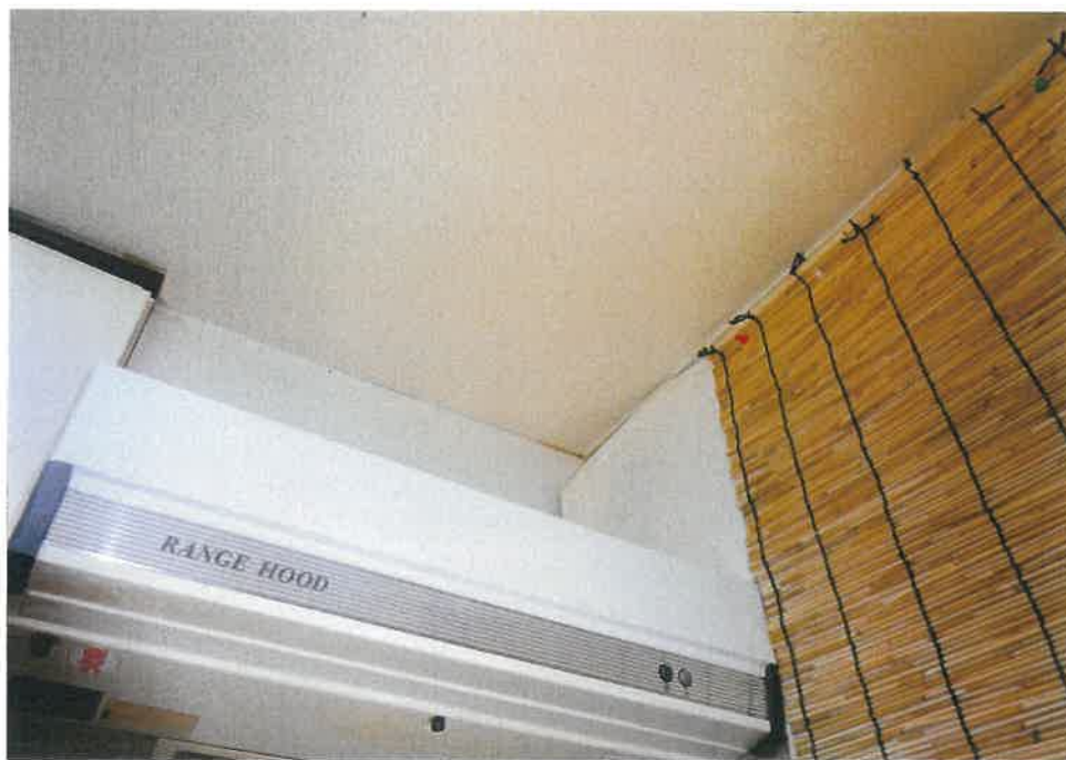
(45) 3階 301号室 台所の天井クロスの剥離
