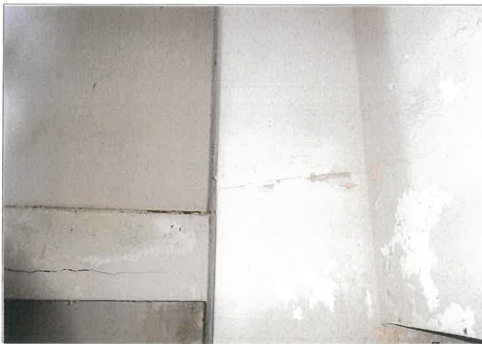
(13) 2階階段付近の壁の損傷
