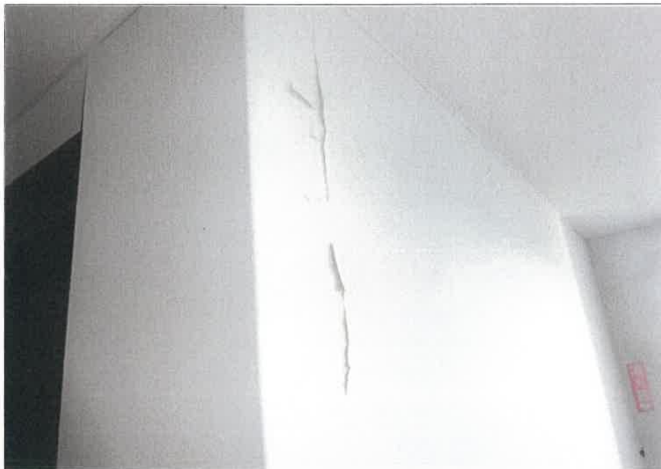
(21) 4階ホールの壁の損傷
