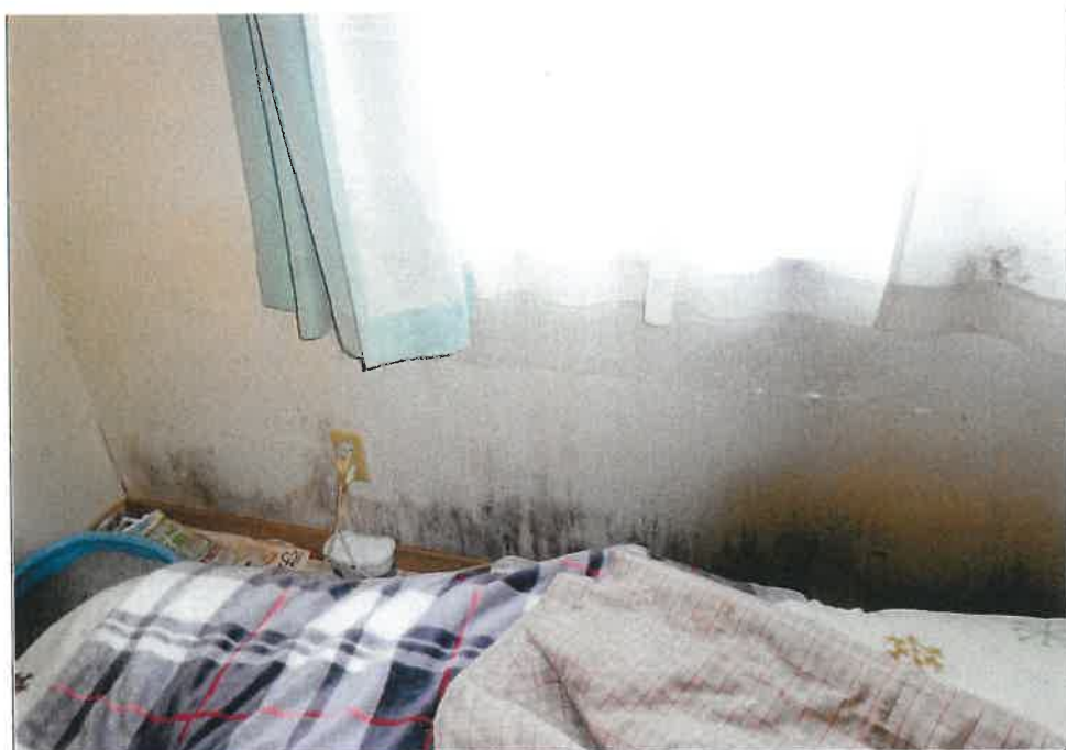
(64) 5階 502号室 洋室1の壁の黒カビ
