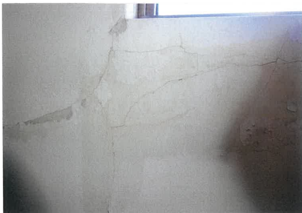
(22) 4階ホールの壁の損傷
