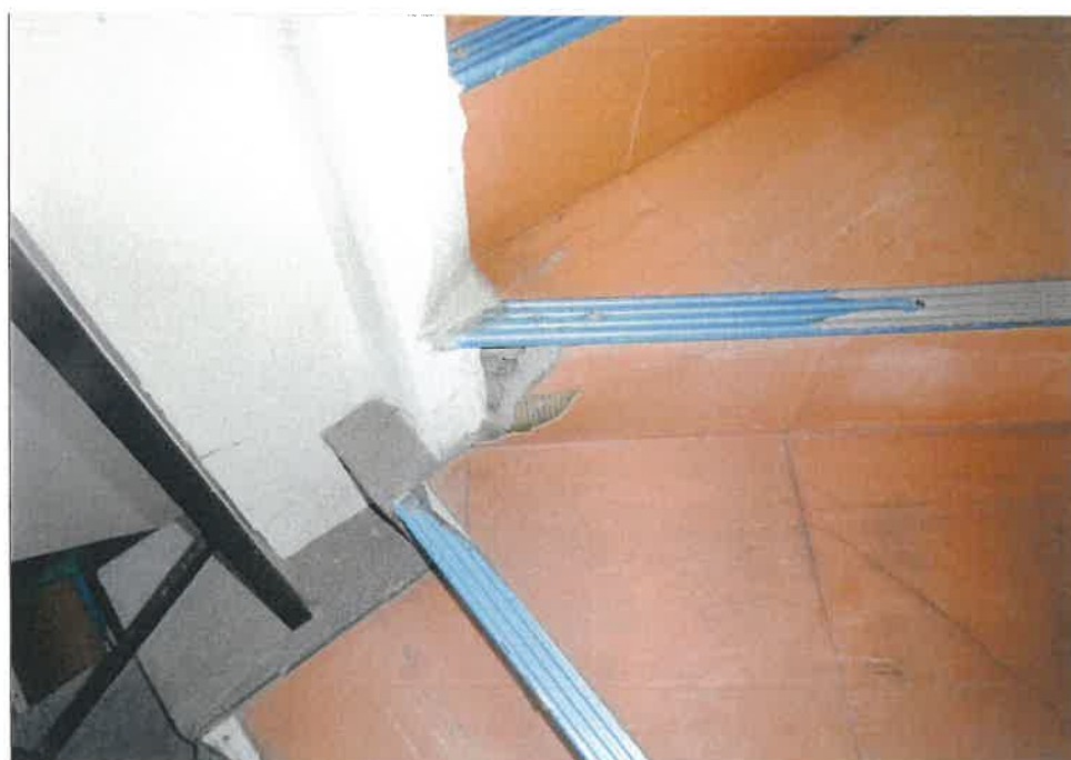
(14) 2階階段部分の損傷
