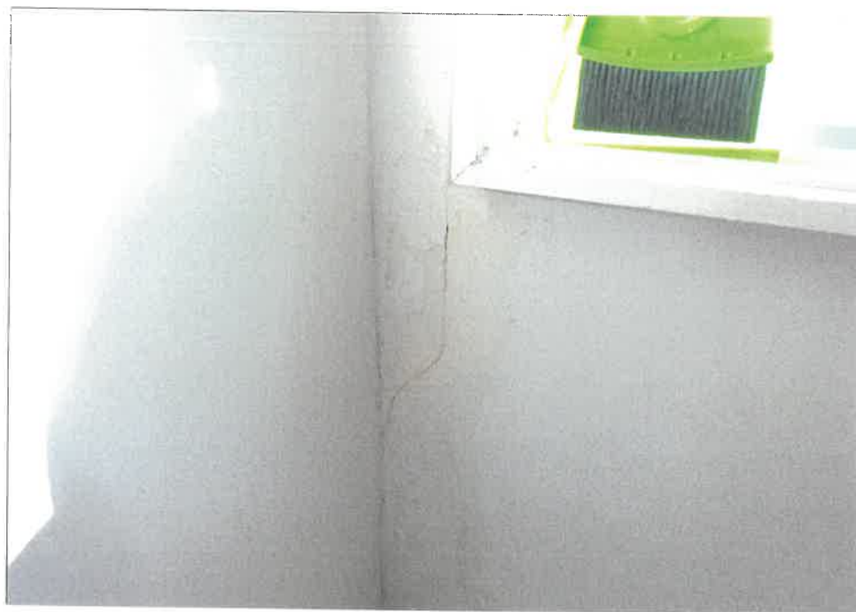
(20) 3階ホールの壁の損傷
