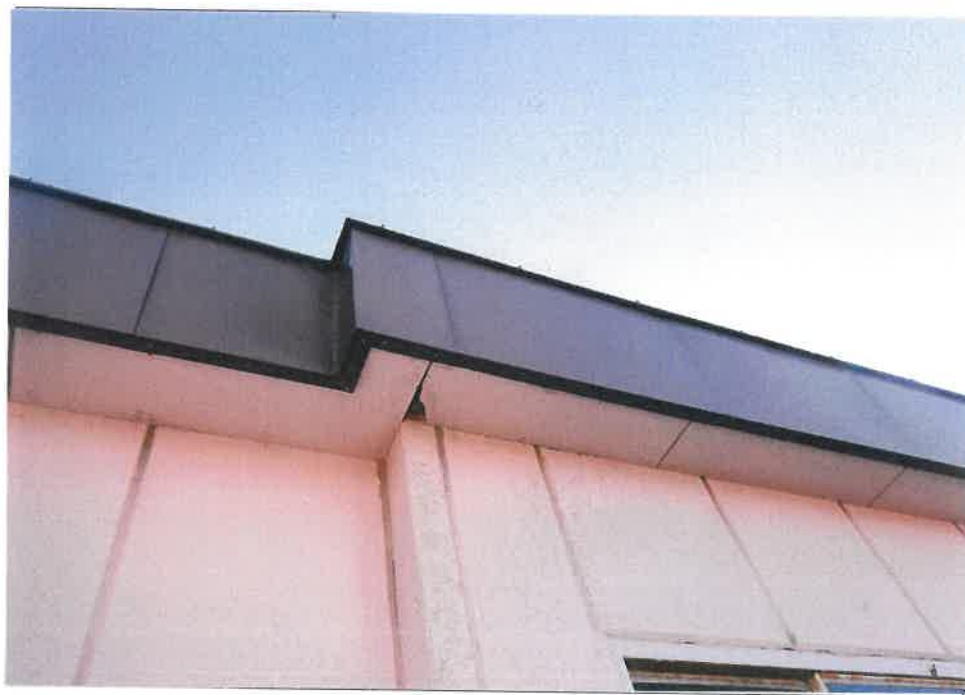
(29) 6階 機械室の軒天の損傷
