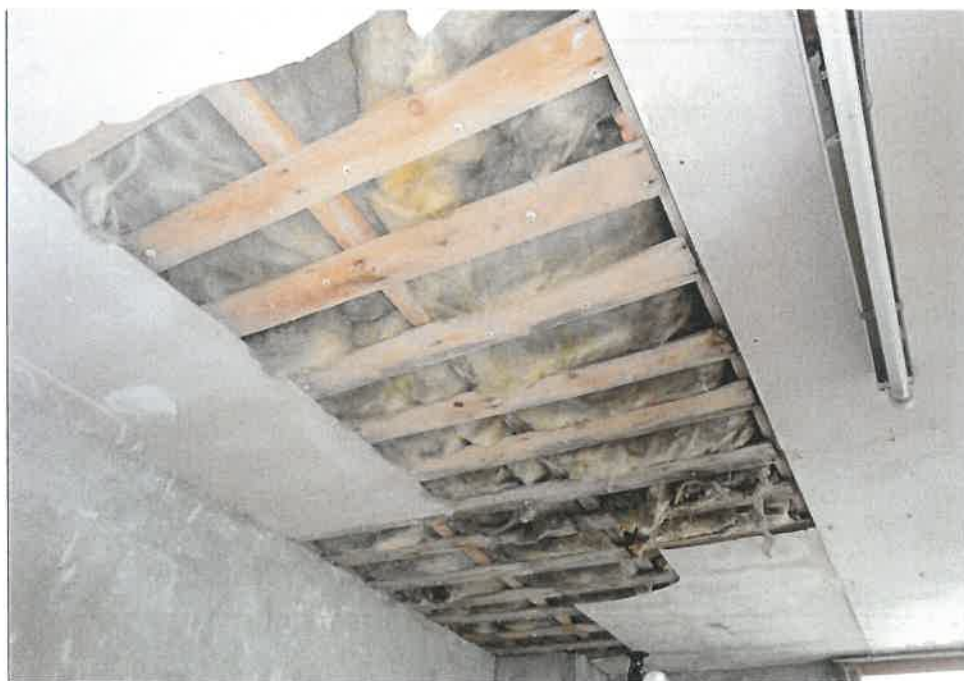
(8) 1階 駐車場の天井の損傷
