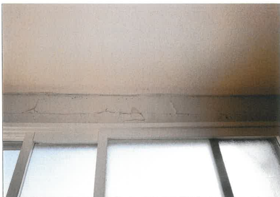
(16) 2階ホールの壁の損傷
