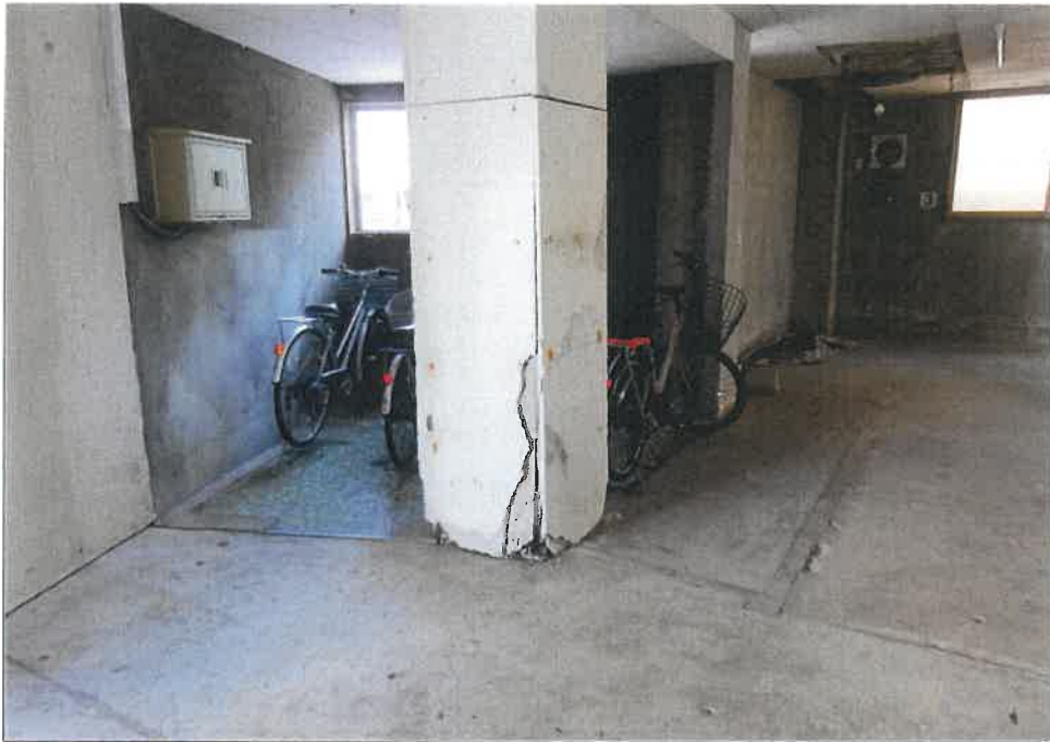
(7) 1階 駐車場の壁等の損傷
