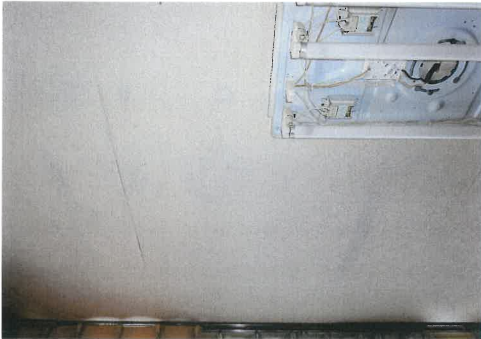
(67) 5階 502号室 洋室2の天井の雨漏り跡
