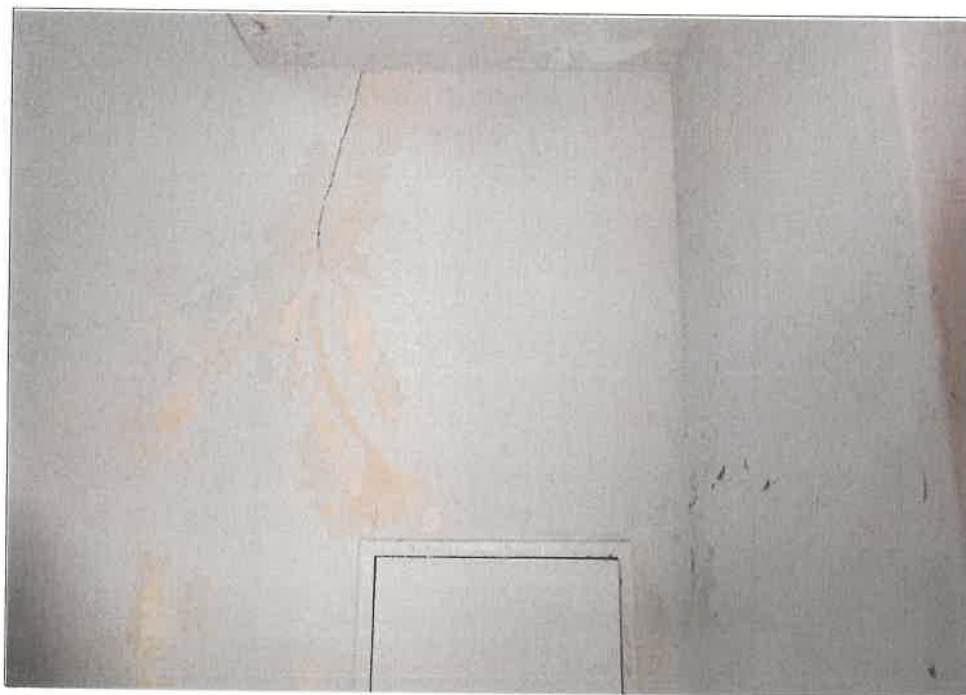
(9) 1階 駐車場の壁の損傷
