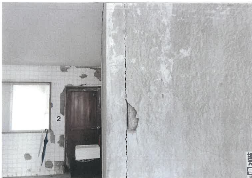
(6) 1階 駐車場の壁の損傷
