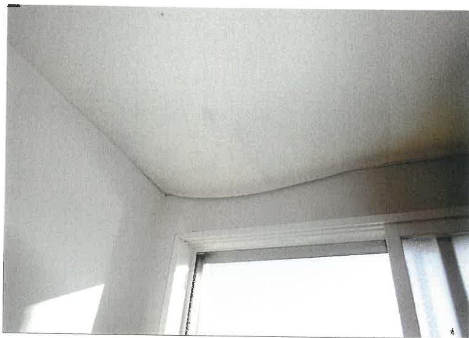
(19) 3階ホールの天井の歪み
