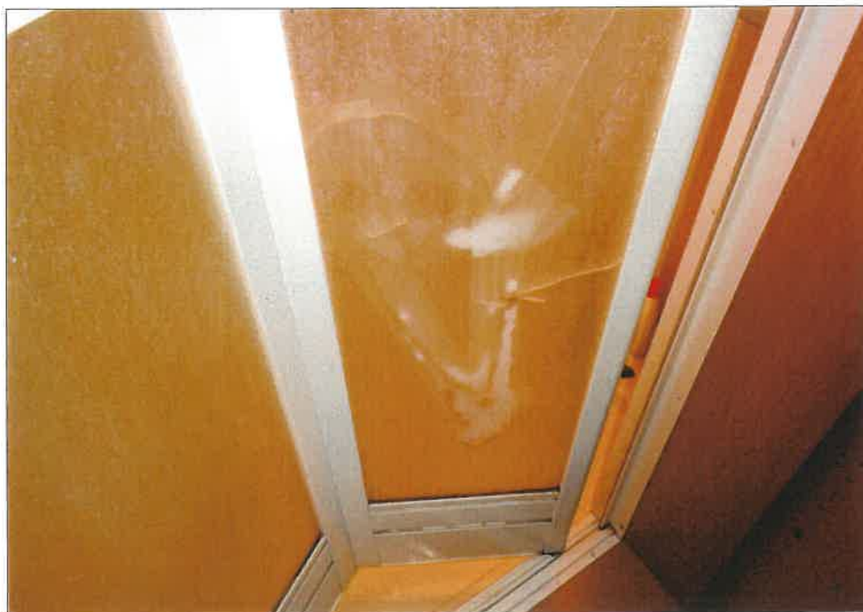
(63) 5階 502号室 浴室の折戸の損傷
