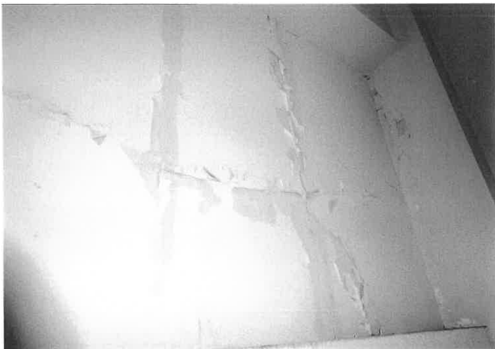
(18) 2階ホールの壁の損傷
