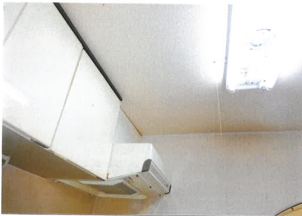
(53) 4階 401号室 台所の換気扇付近の雨漏り跡
