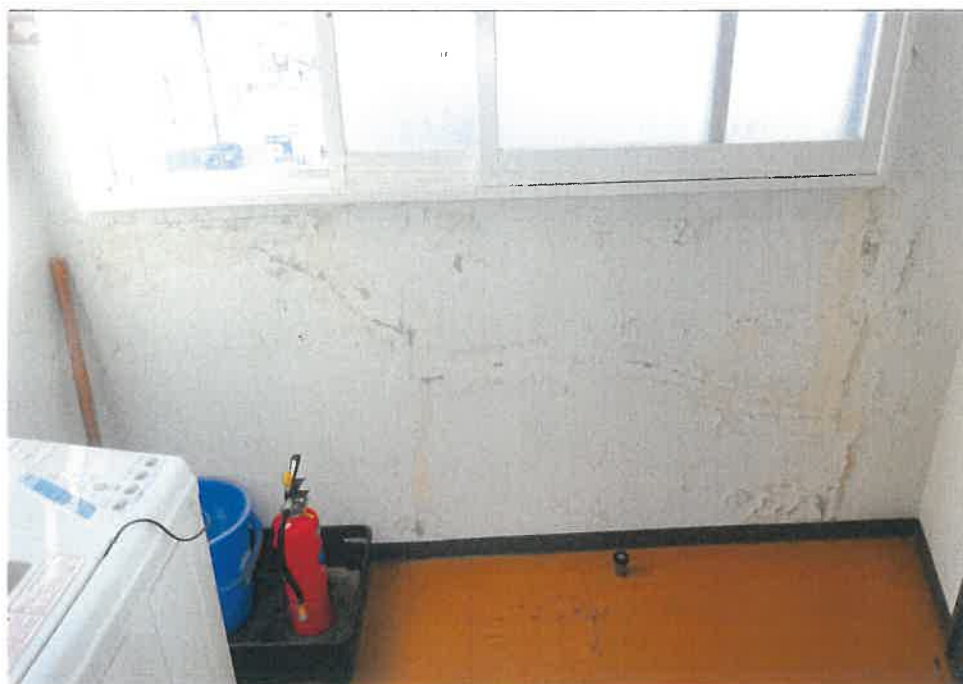
(15) 2階ホールの壁の損傷
