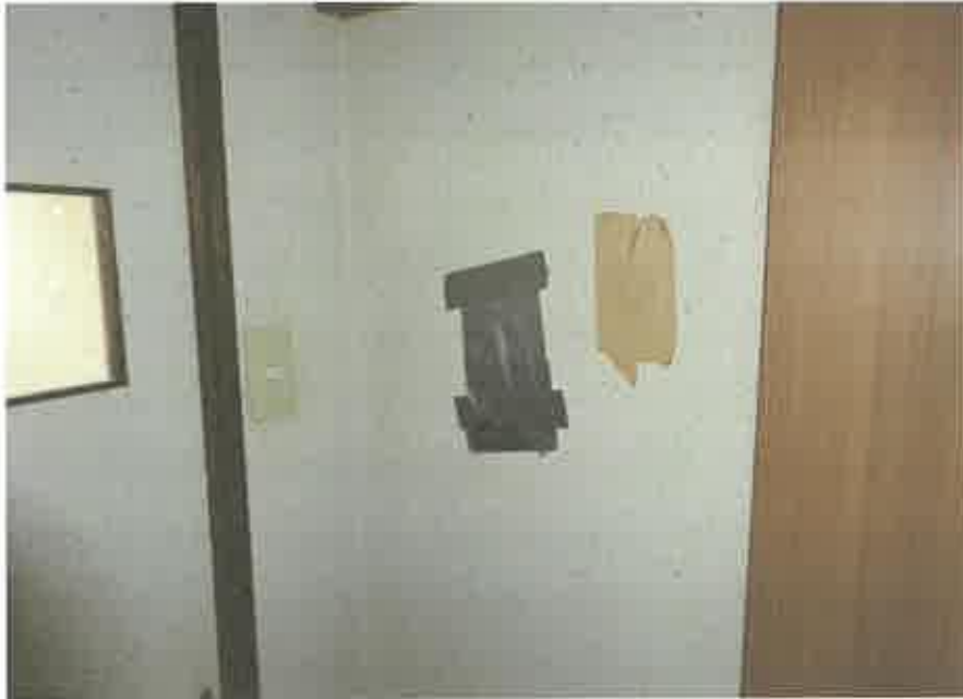
1 階脱衣室の壁の損傷状況
