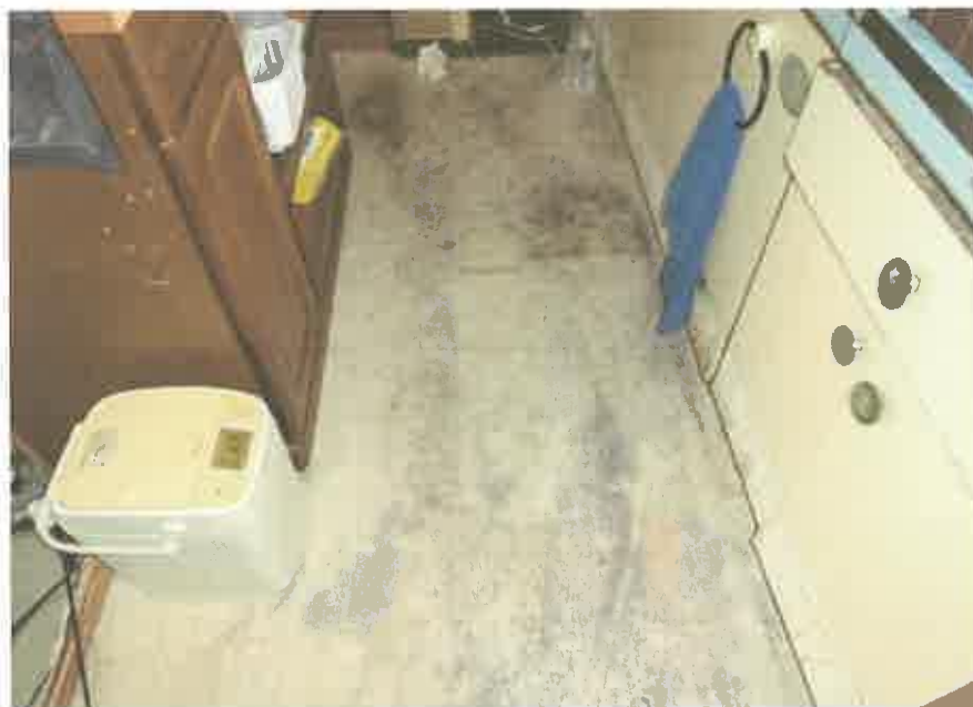
1階台所床の汚損状況
