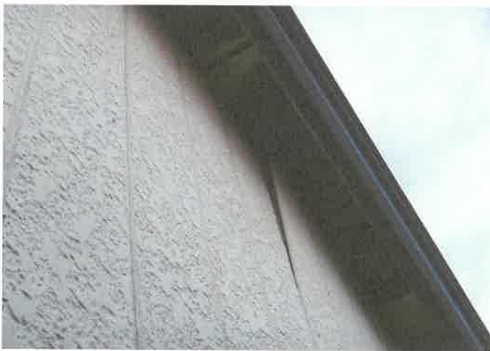
未登記附属建物（車庫）の外壁の損傷
