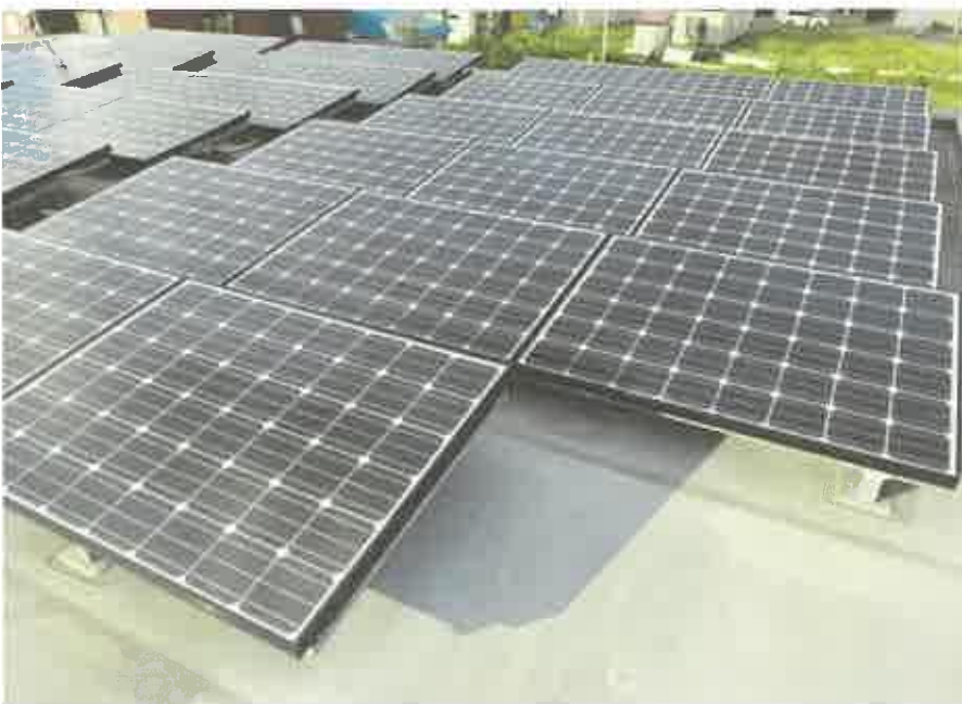
屋上に設置された太陽光パネル
