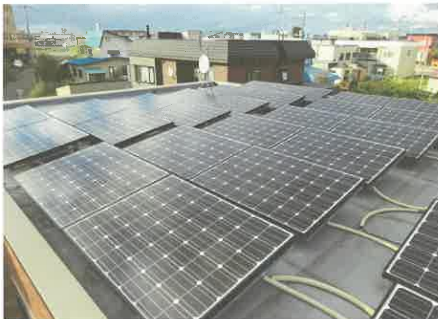
屋上に設置された太陽光パネル
