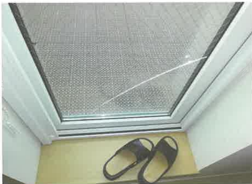
2階ホールのガラスドア（バルコニーへの出入り口）の破損状況
