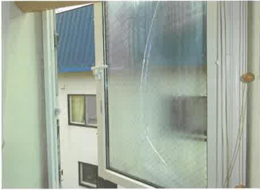
2階洋室1の窓ガラスの破損状況
