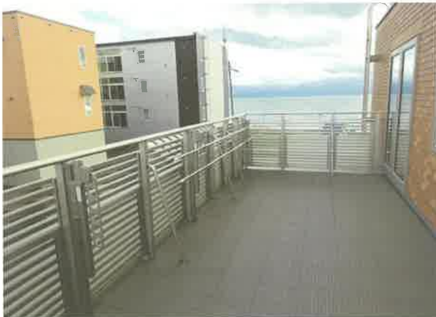
2階バルコニー（本件建物の略南東側）
