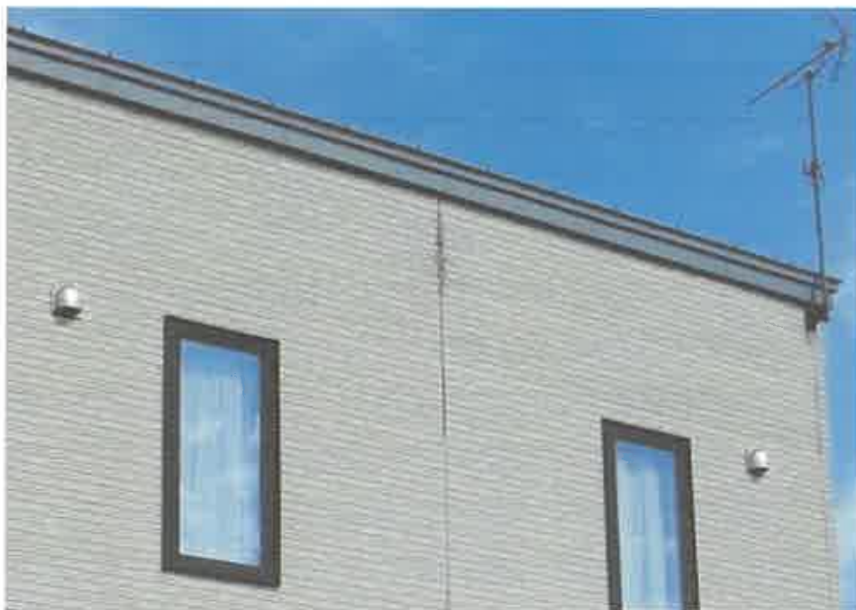
外壁コーキングの劣化
