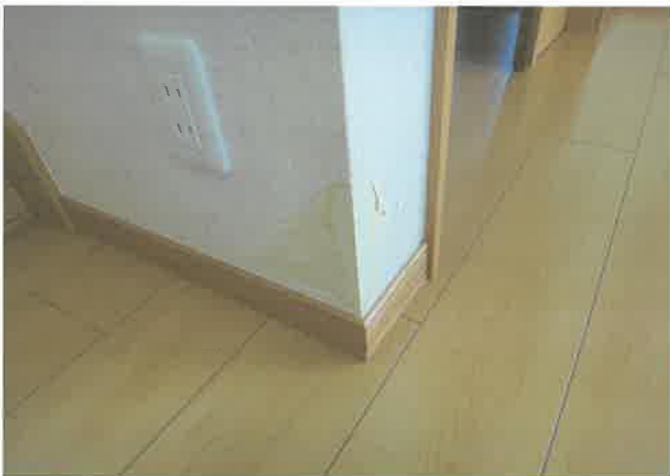
1階階段付近の壁クロスの損傷
