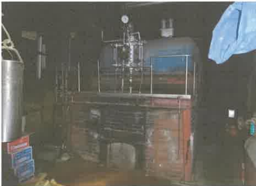
物件4 建物（工場・乾燥所）の内部の状況（ボイラー）
