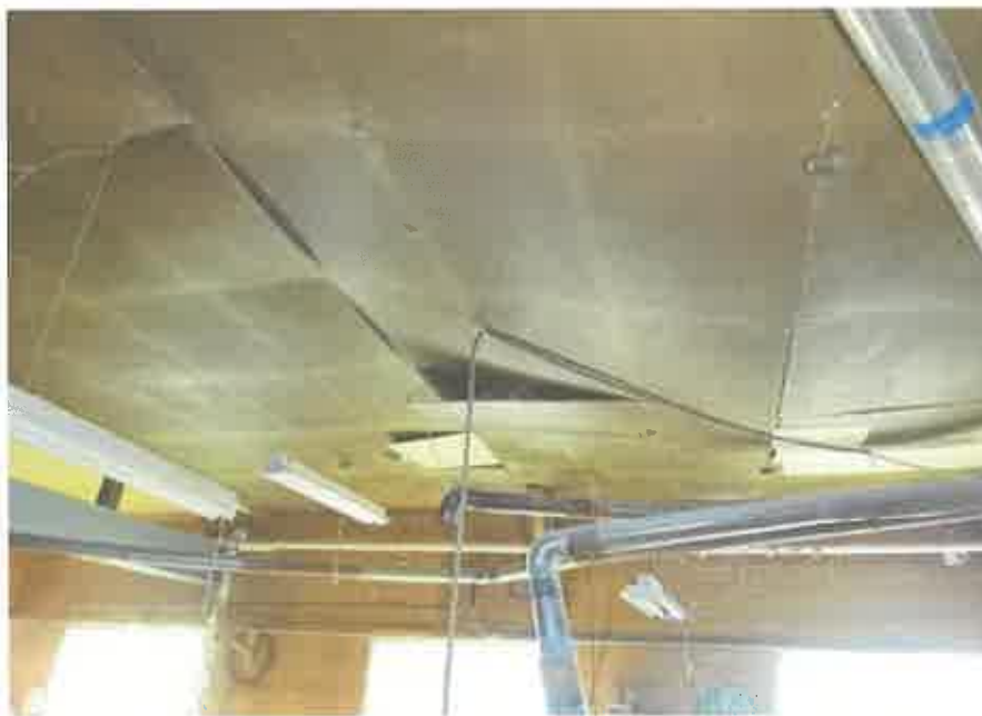
物件3の附属建物（符号2）である倉庫内の天井の損傷状況
