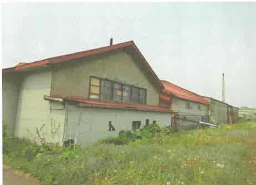
物件4 建物（工場・乾燥所）の外観 （倒壊した煙突の状況）
