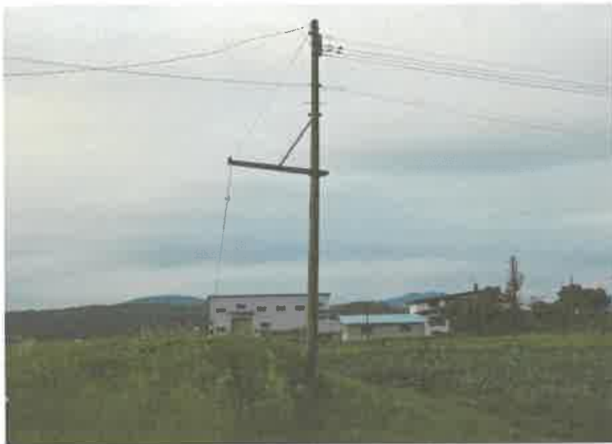
北海道電力ネットワーク所有の電柱及び支線
