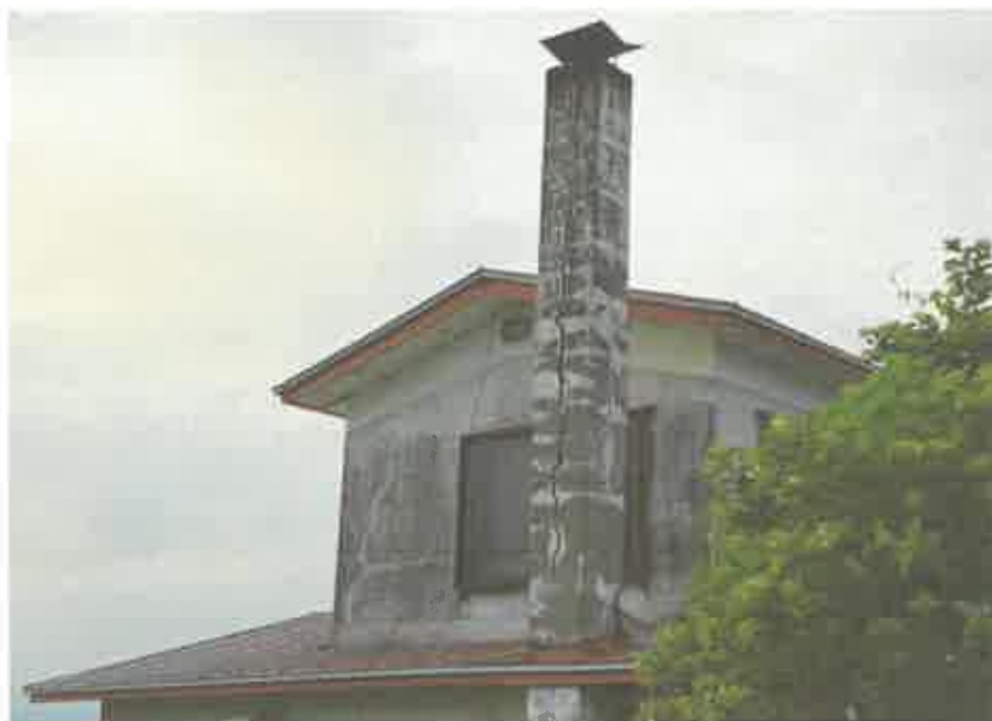
煙突の亀裂の状況
