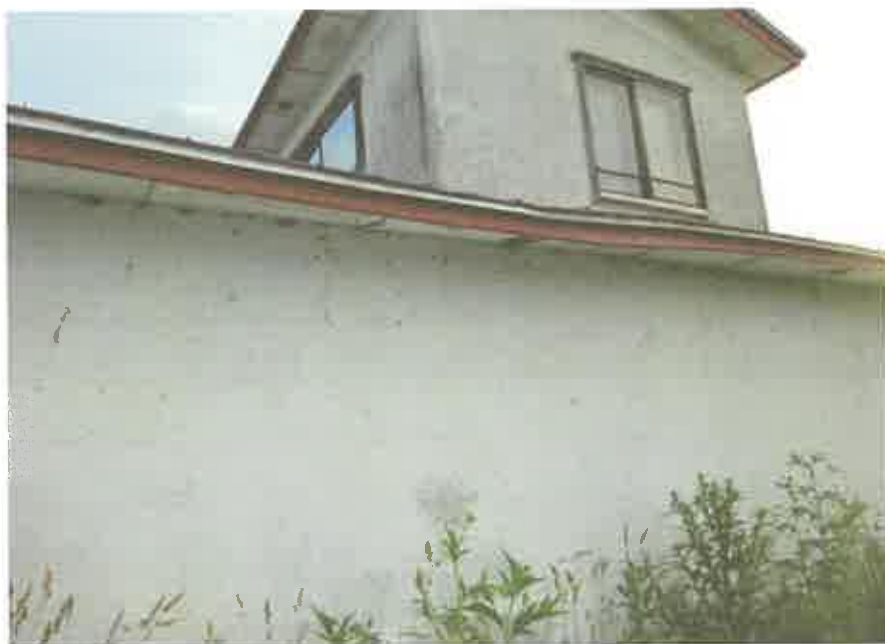
1 階の軒天の損傷状況
