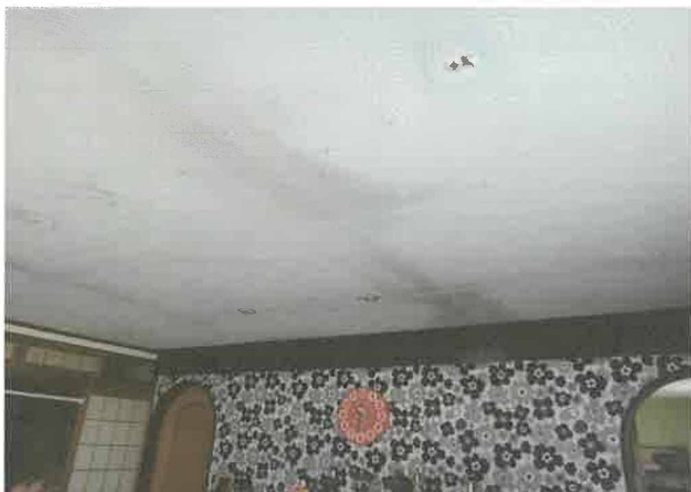
居間の天井クロス黒ずみ及び照明の設置跡
