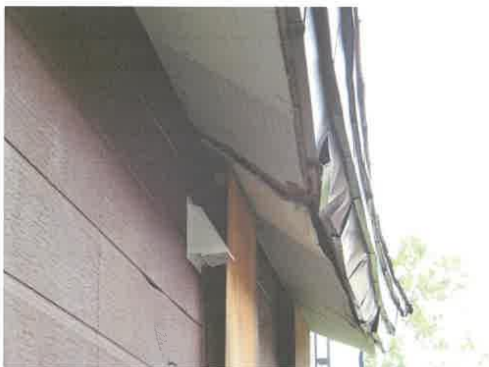
略南東側屋根の撓み及び軒裏ボードの損傷
