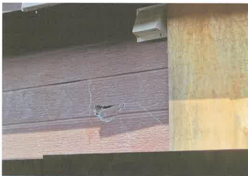
略南東側外壁の損傷
