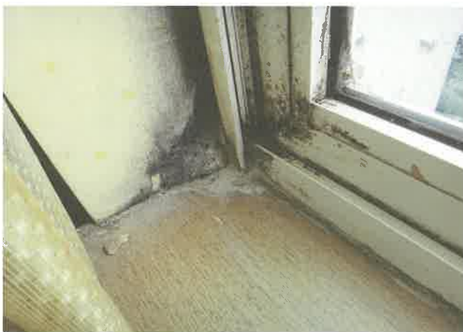
2階洋室3の窓枠及び壁クロスの汚損
