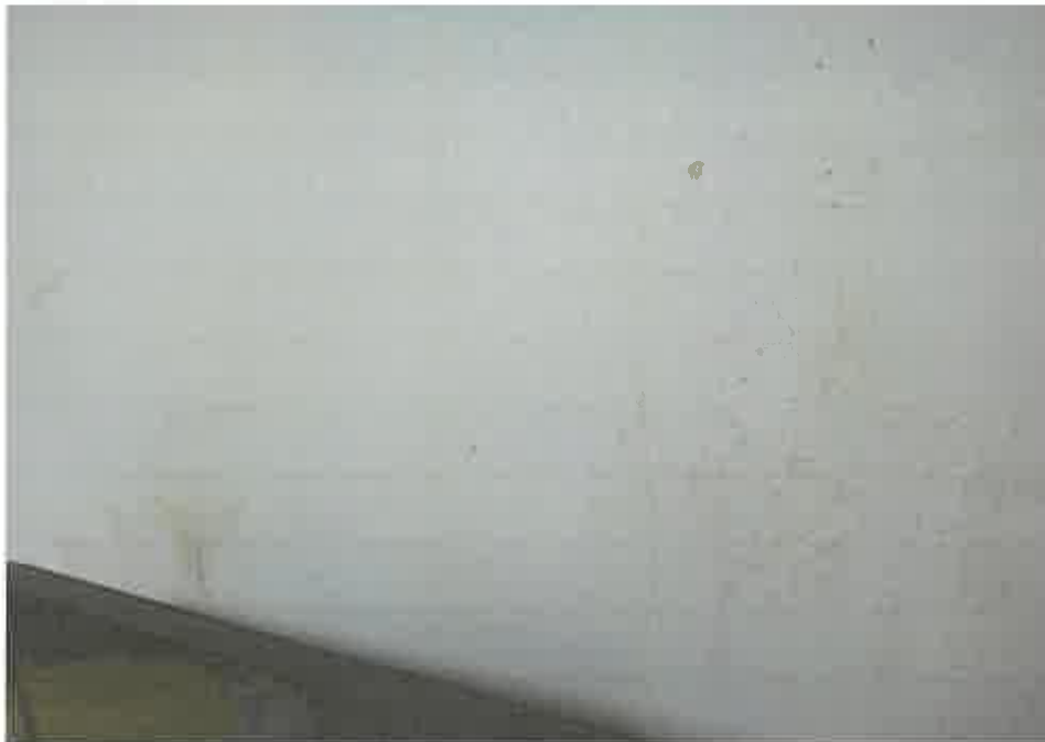
1 階居間の壁クロスの劣化、汚損
