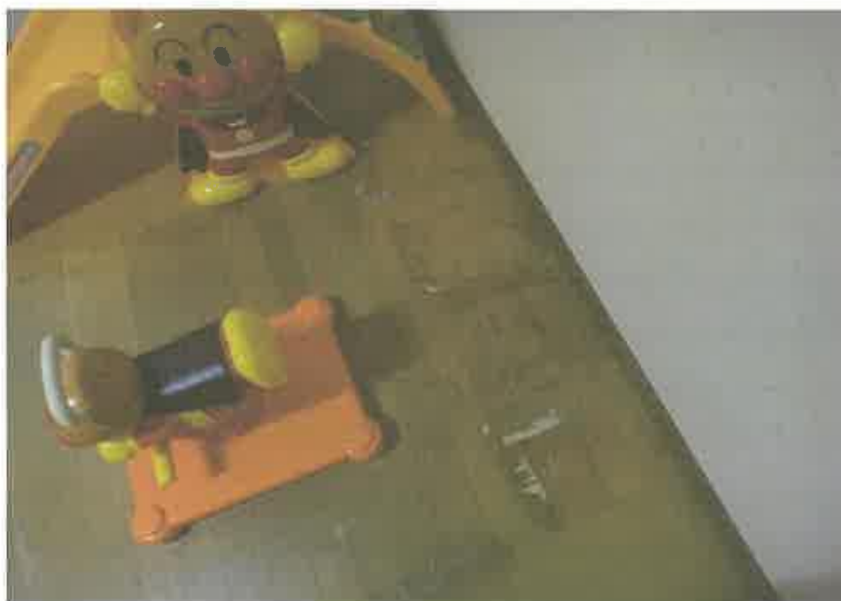
2階洋室4の床の損傷
