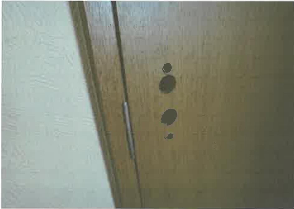
1 階物入のドアのぶの欠損
