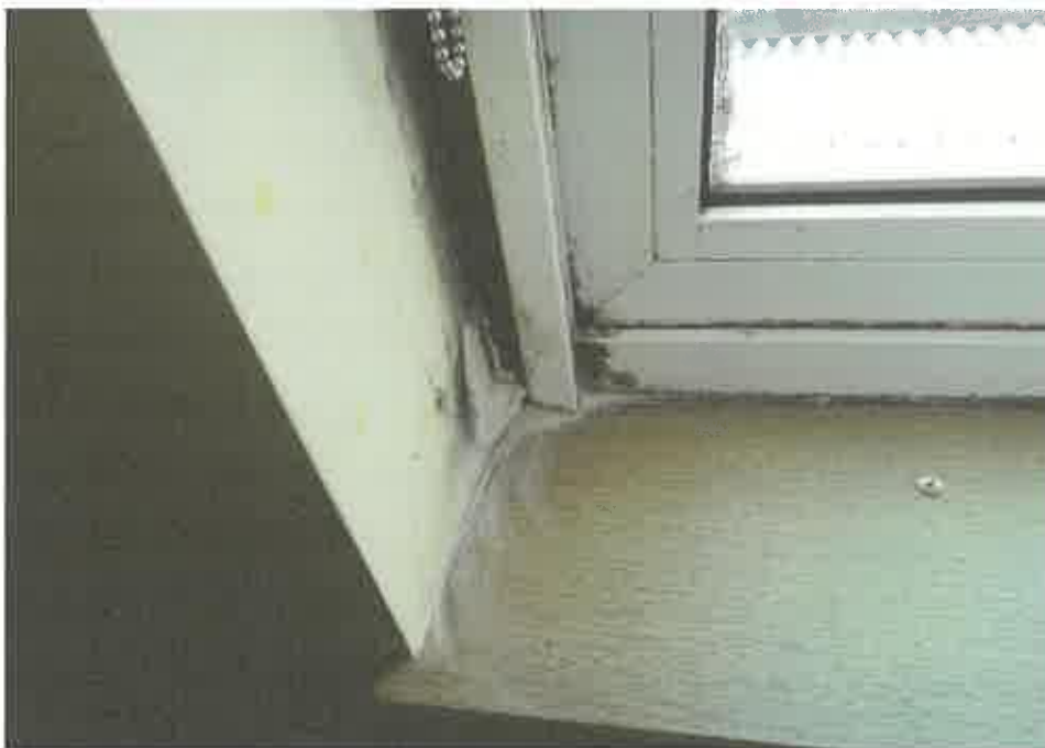
2階洋室4の窓枠及び壁クロスの汚損
