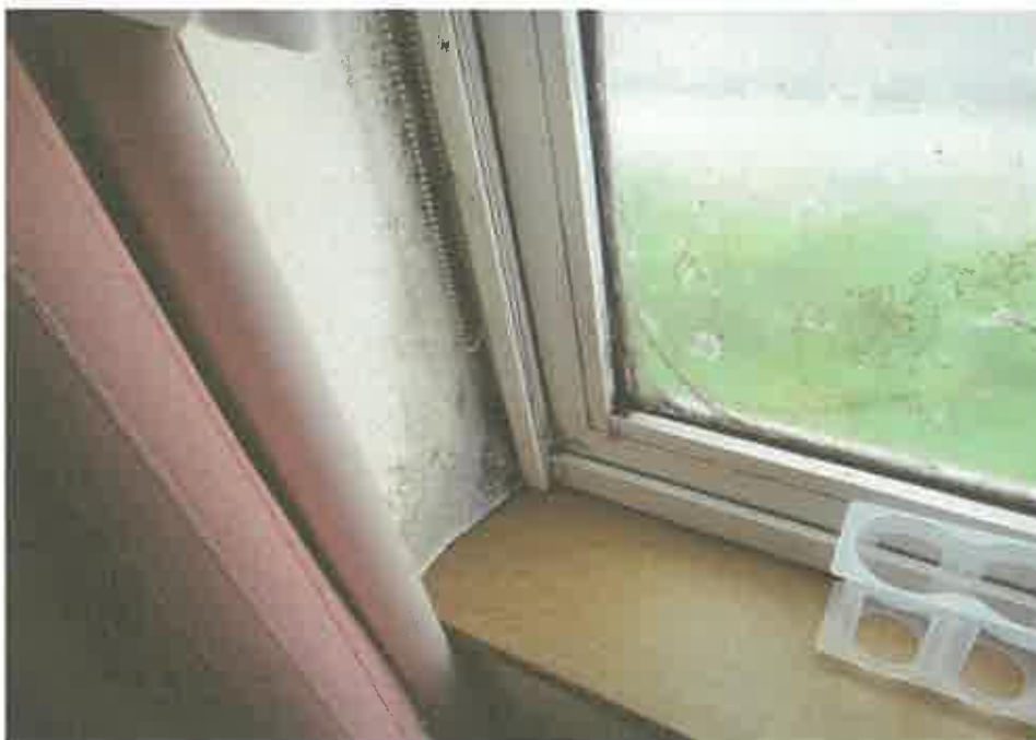
1 階居間の窓枠及び壁クロスの汚損
