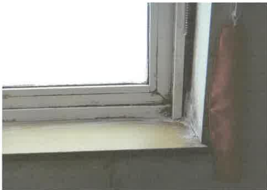
2階洋室2の窓枠及び壁クロスの汚損
