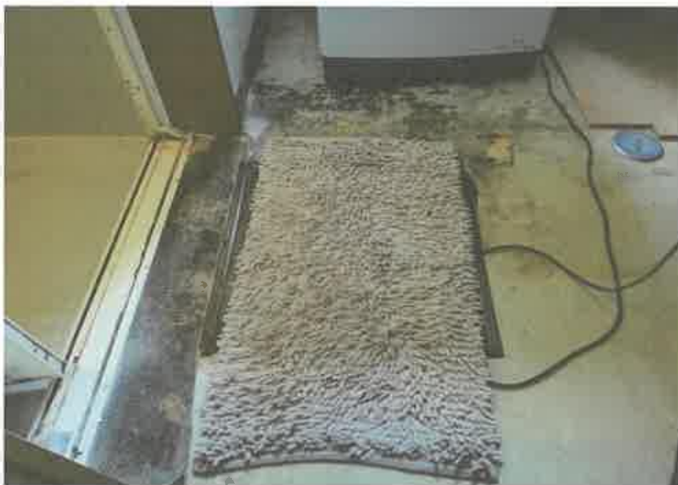
1 階ユーティリティーの床の汚損
