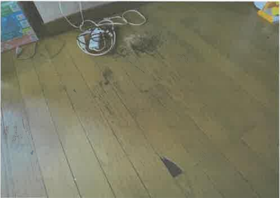
1 階居間の床の損傷
