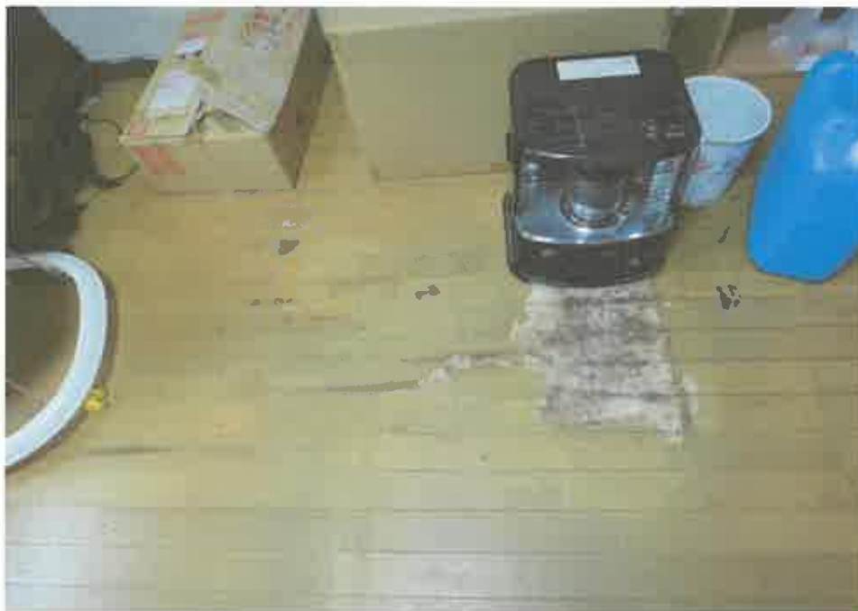
1 階洋室 1 の床の汚損
