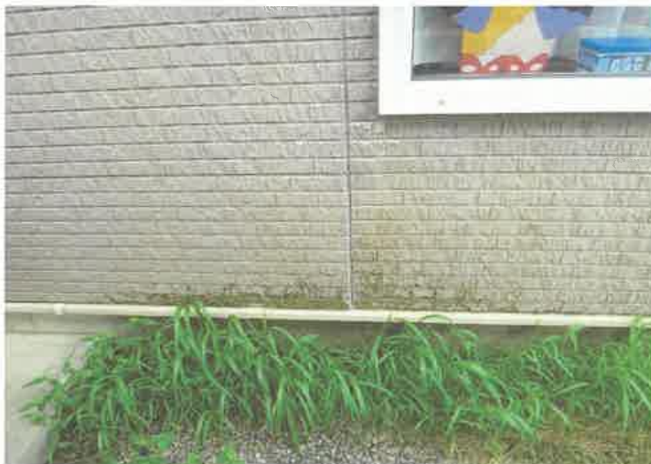
本件建物の外壁の劣化
