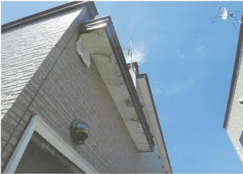
本件建物の軒裏の一部の損傷状況
