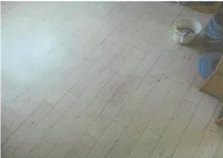
2 階洗濯室の床の染み
