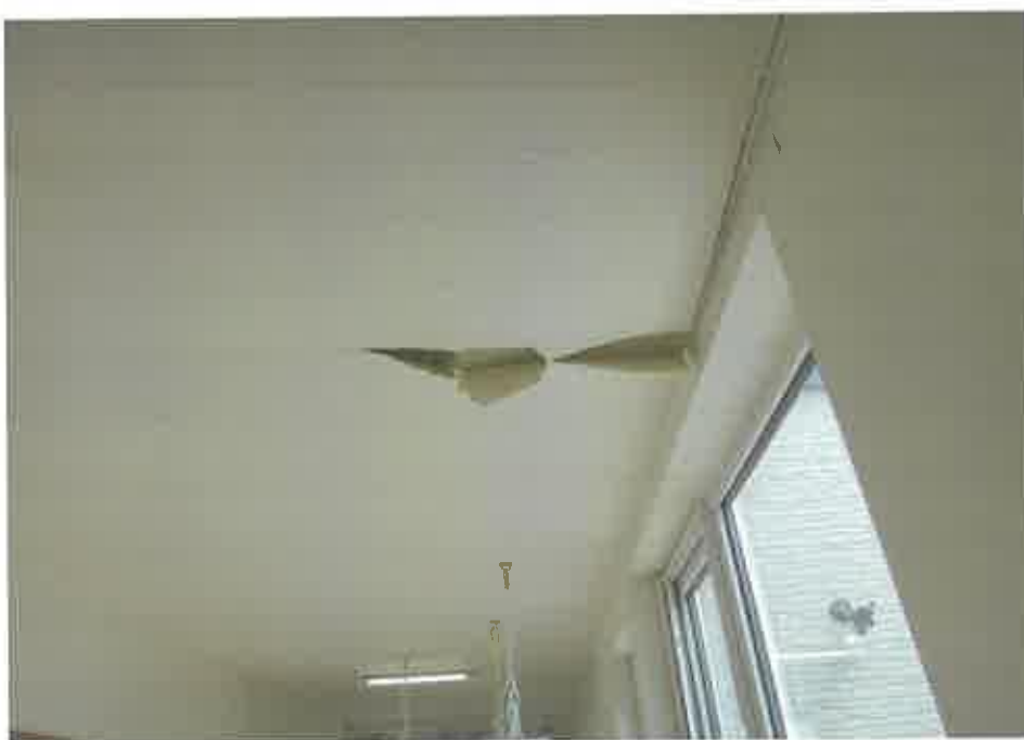
2階洗濯室前廊下の天井の雨漏り跡
