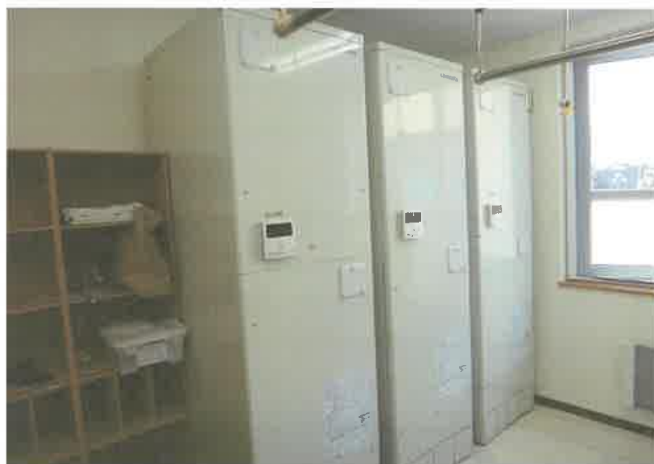
2階洗濯室内に設置されている電気温水器3台
