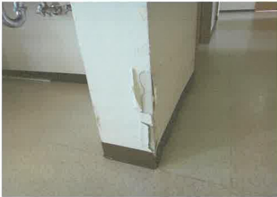
1 階トイレ 2 の横の壁クロスの剥がれ
