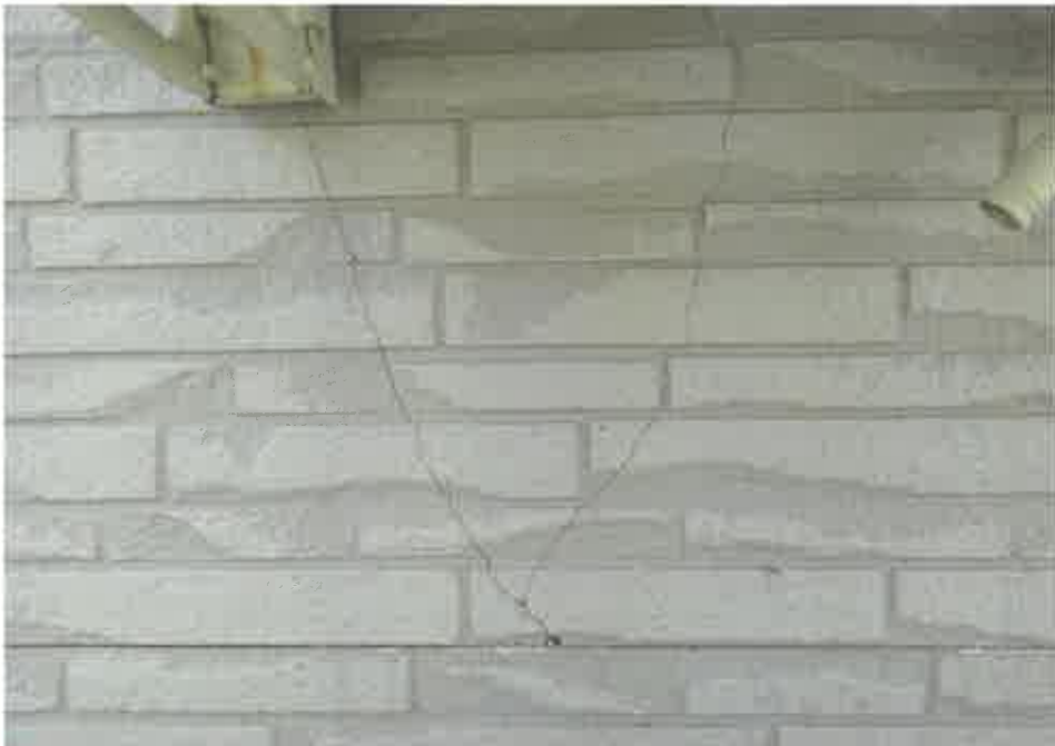
外壁のひび割れ
