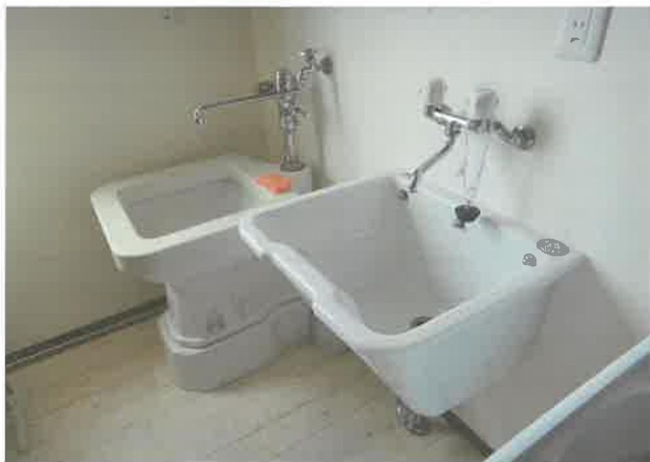
2階洗濯室内に設置されているシンク
