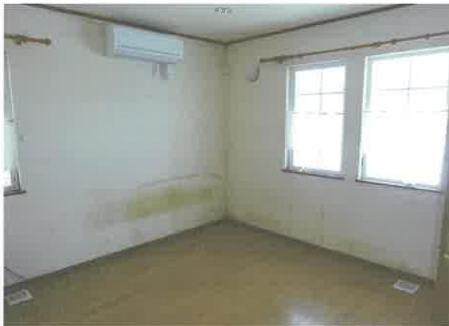
2階洋室3（結露による黒カビの状況）
