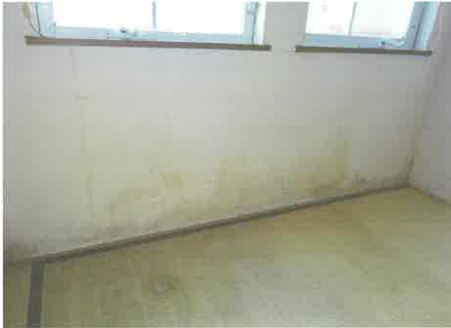
1 階和室の結露による黒カビの状況
