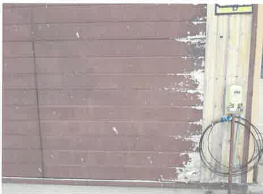
略北西側玄関横の外壁の損傷状況
