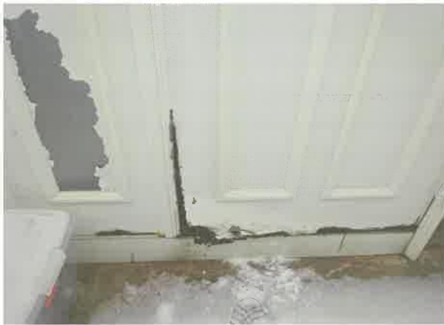
中央1号室の玄関ドア下部の損傷状況
