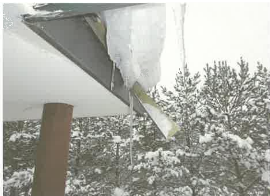
中央1号室玄関ポーチ上の軒天の損傷状況
