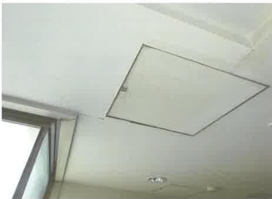
5階504号室及び505号室前の天井クロスの歪み等の状況
