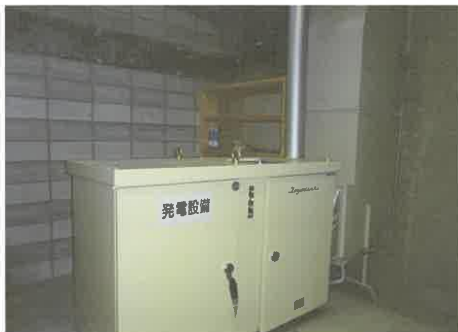
1 階電気室内の非常用電源設備
