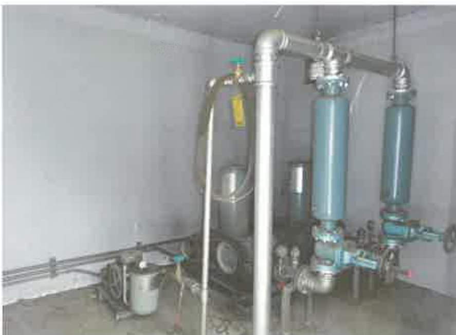
浄化槽ポンプ設備内部
