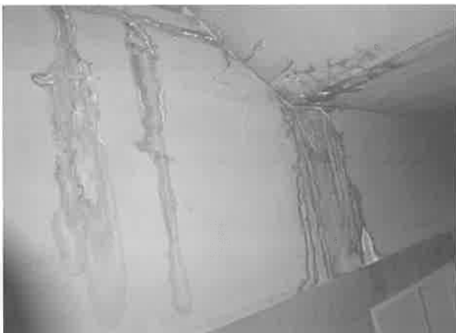
3 階南側階段室の漏水跡
