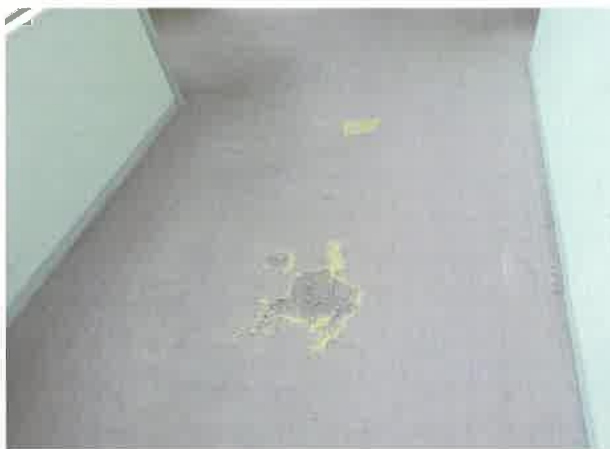
4 階 4 0 5 号室前の廊下の床材の損傷状況
