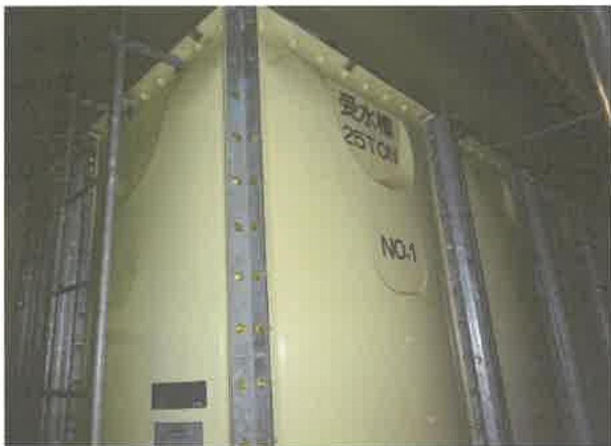
1 階受水槽室内の受水槽
