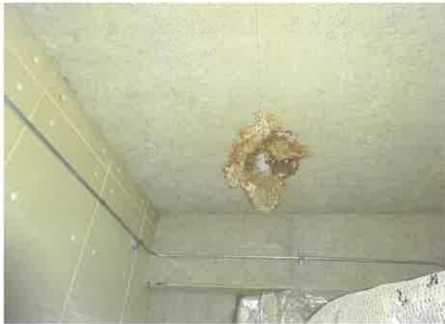
3 階ファン室天井の漏水跡及び損傷状況
