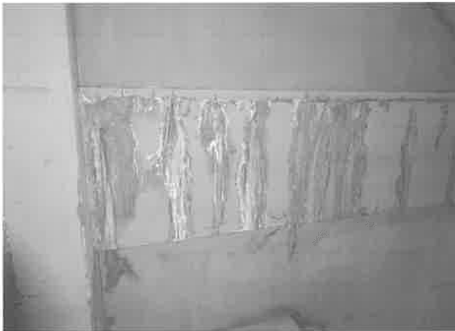
3 階南側階段室の漏水跡
