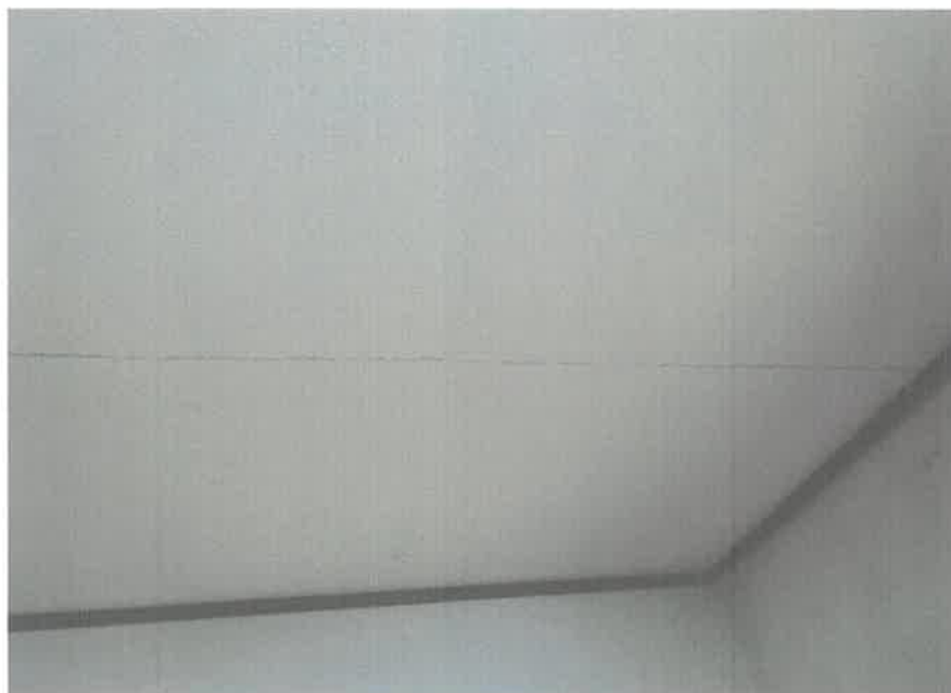
2階洋室Bの天井の亀裂
