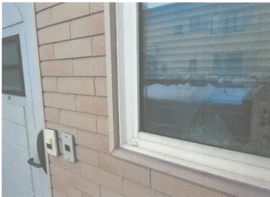
1階玄関横の窓の破損状況
