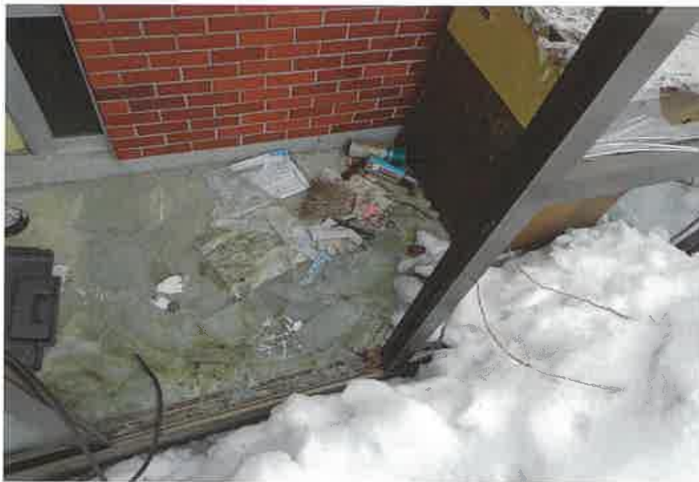
風除室 ガラスの破損
