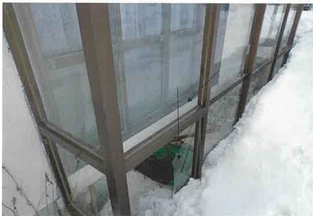
サンルーム ガラスの破損
