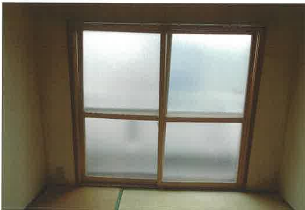
505号室 和室1の窓枠の状況
