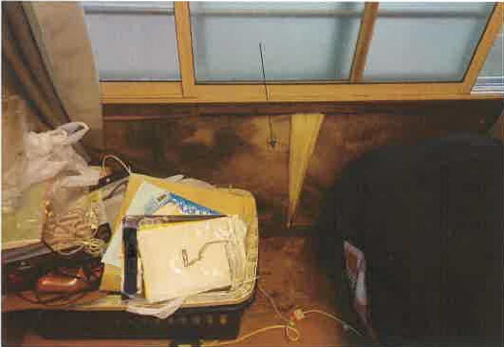
303号室 和室の黒カビの状況
