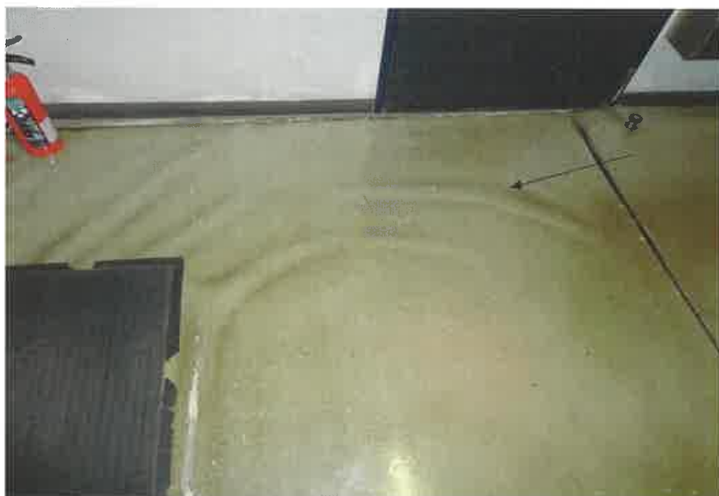
ホール 床材の浮き
