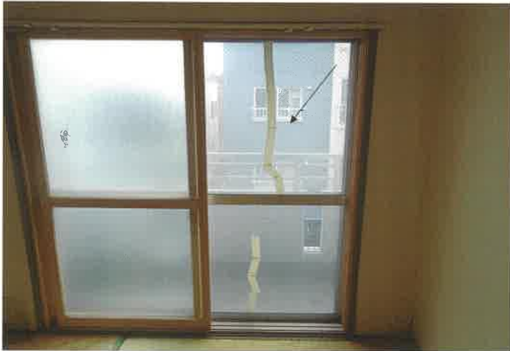
305号室 和室1の窓ガラスの破損
