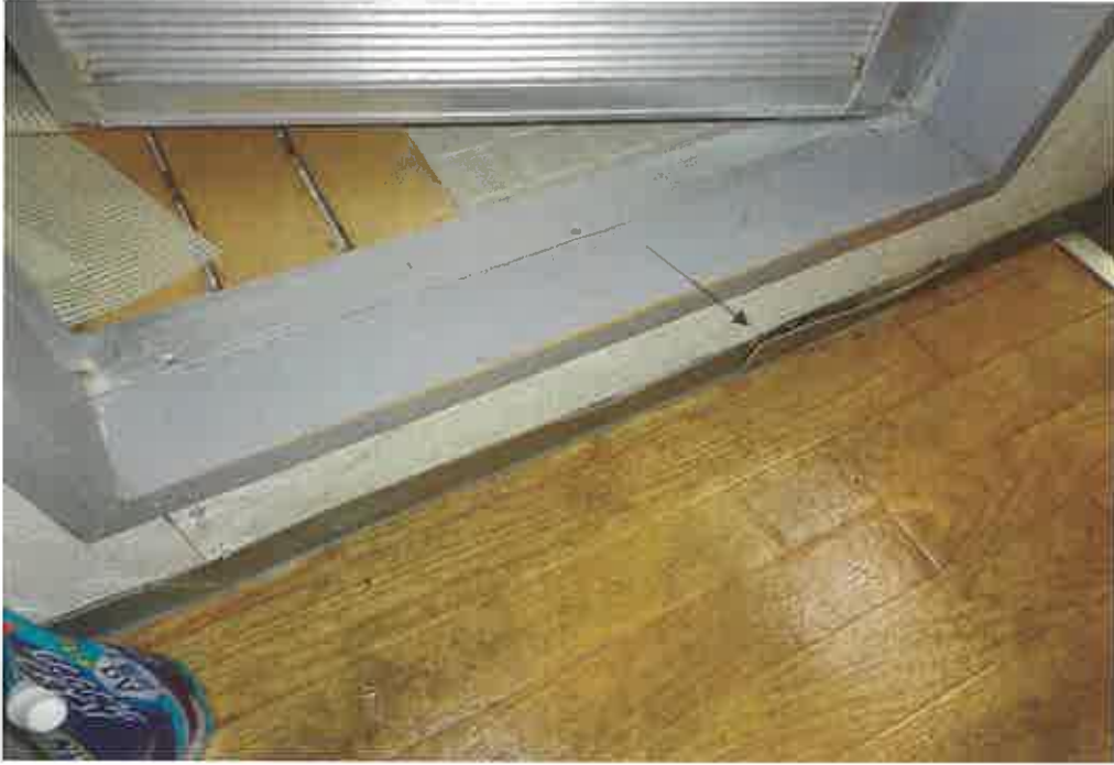
202号室 浴室ドアの損傷
