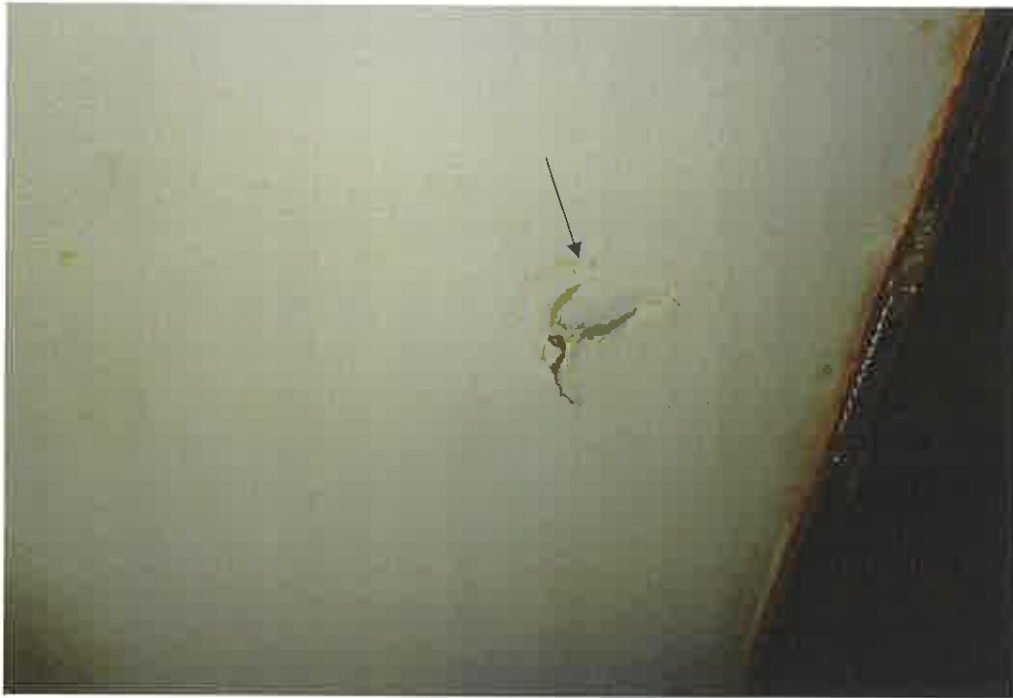
102号室 玄関付近の内壁の陥没
