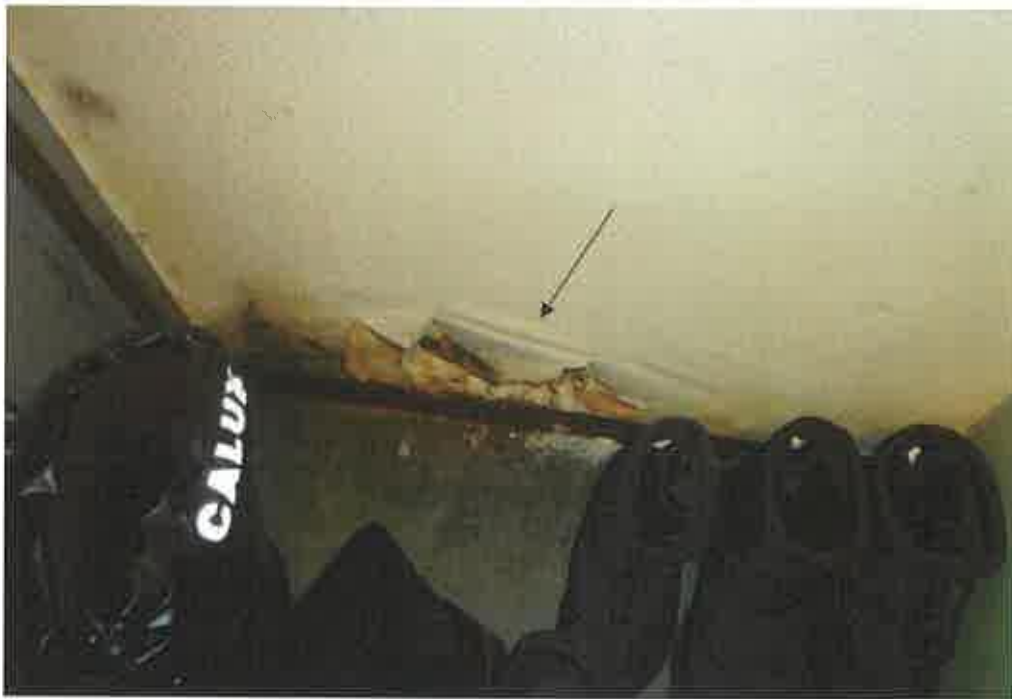
303号室 玄関付近の内壁の陥没
