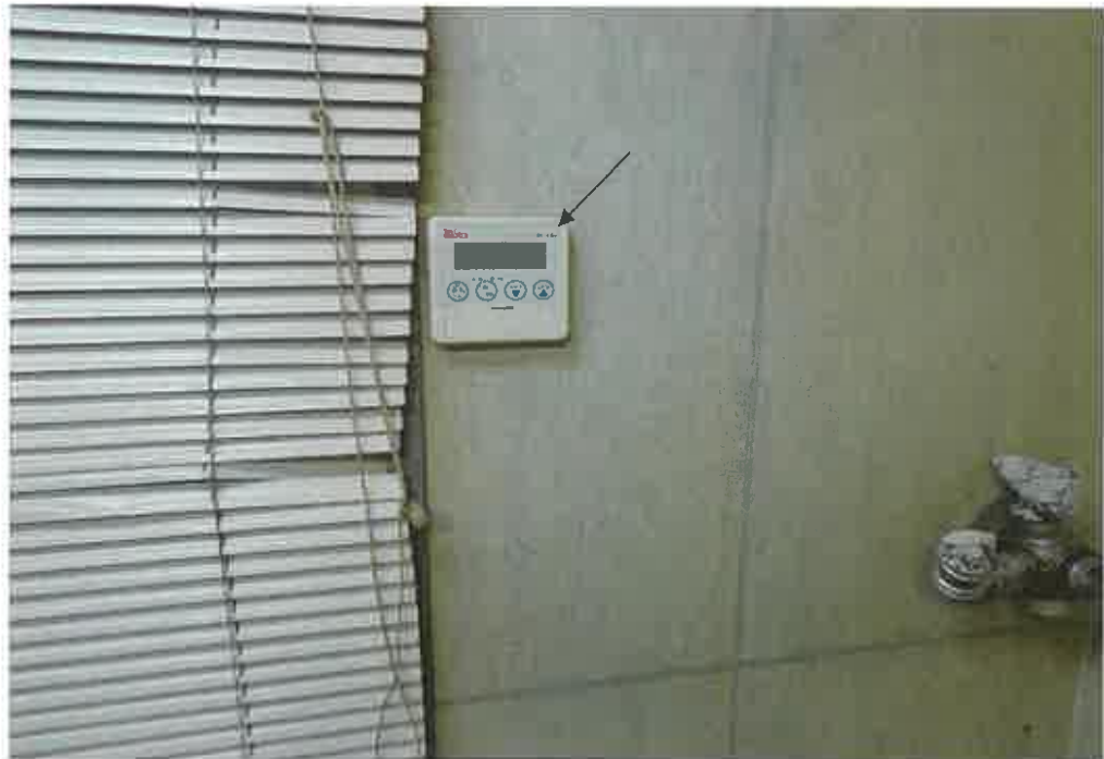
101号室 融雪槽操作盤
