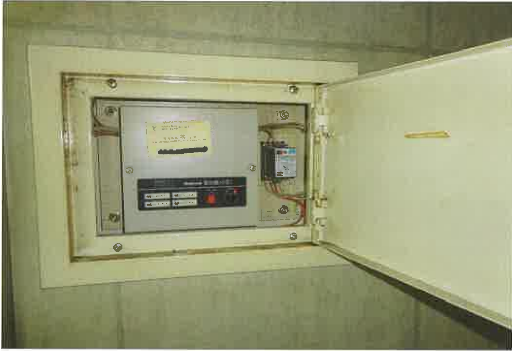
101号室 受水槽警報盤
