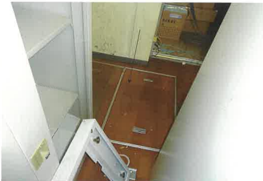
101号室 受水槽出入口
