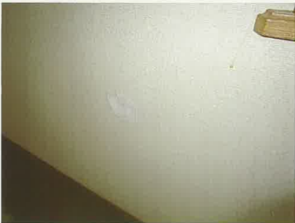
1階階段ホールの補修痕
