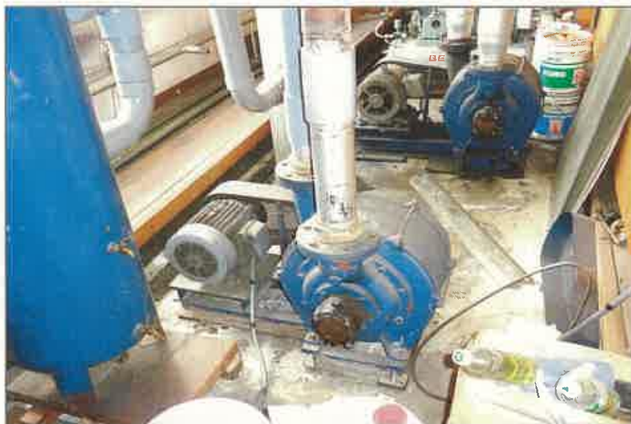
⑯物件4(1階機械室)
