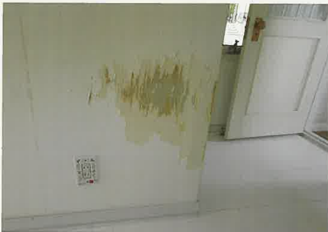
9 2階居間等壁紙（損傷状況）①
