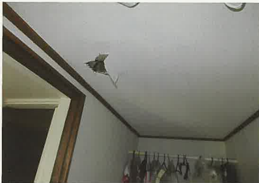
11 1階納戸天井材（損壊状況）
