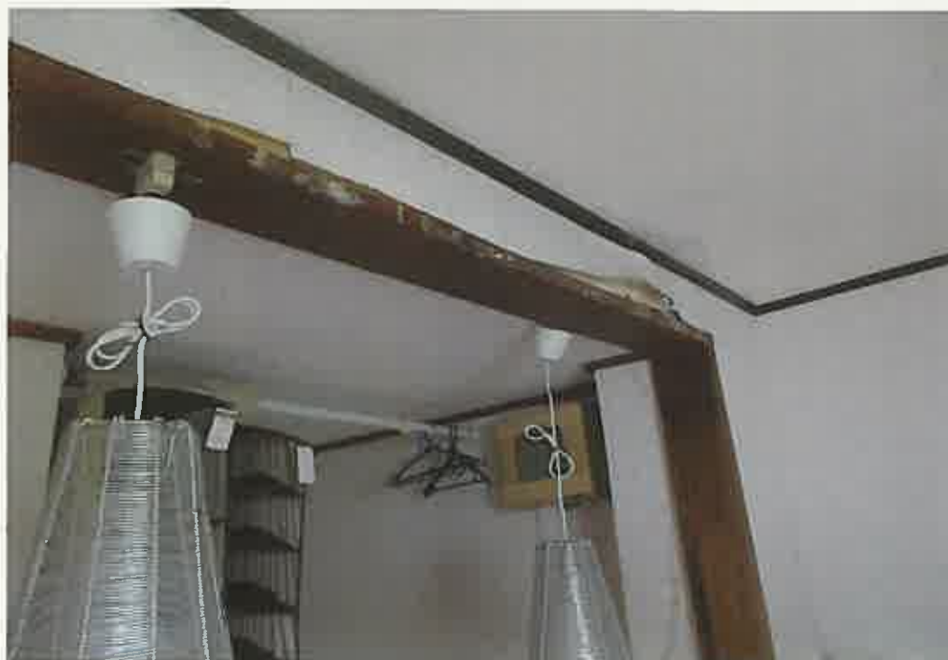
12 1階納戸下がり壁及びその壁紙（損傷、剥離状況）
