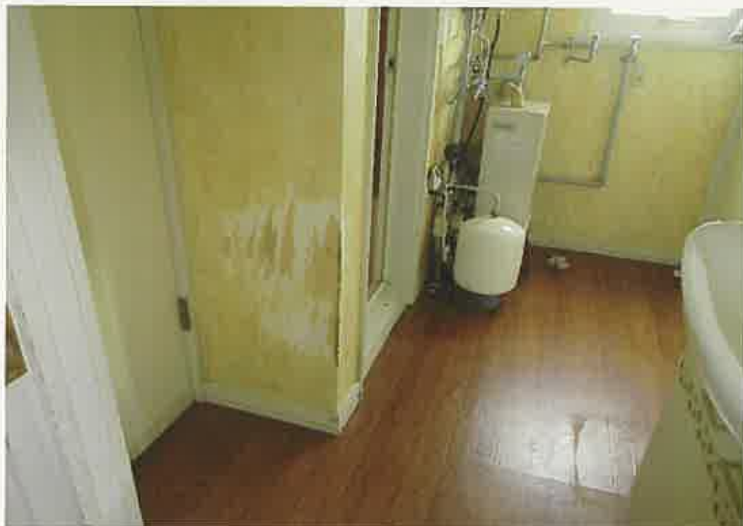
10 2階居間等壁紙（損傷状況）
