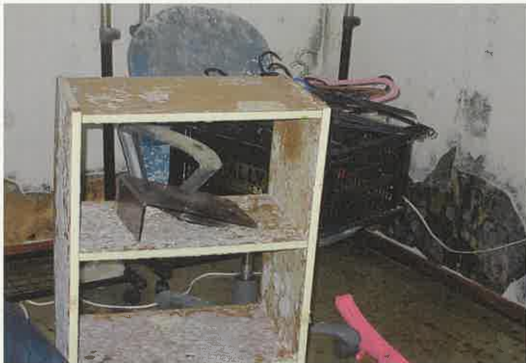
21 地下1階物置2②（汚損状況）
