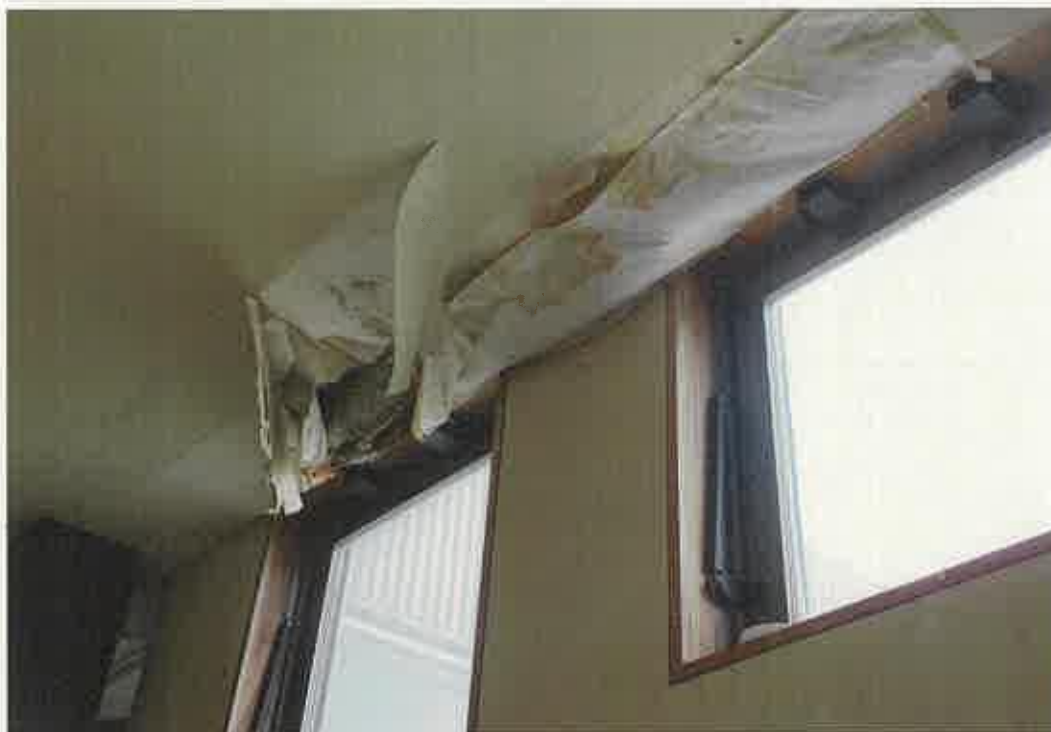
11 2階ホール天井（損壊状況）
