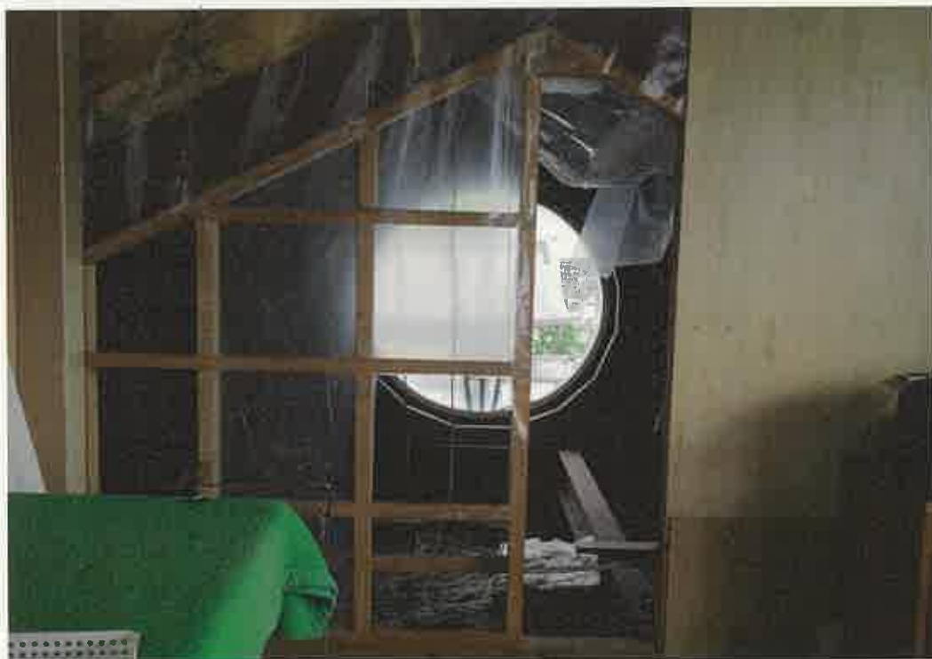
14 3階物置壁（損壊状況）
