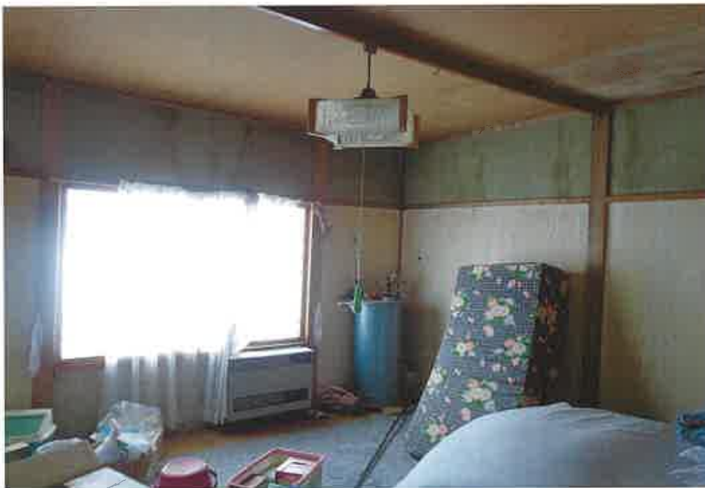
和室3 内壁の汚損
