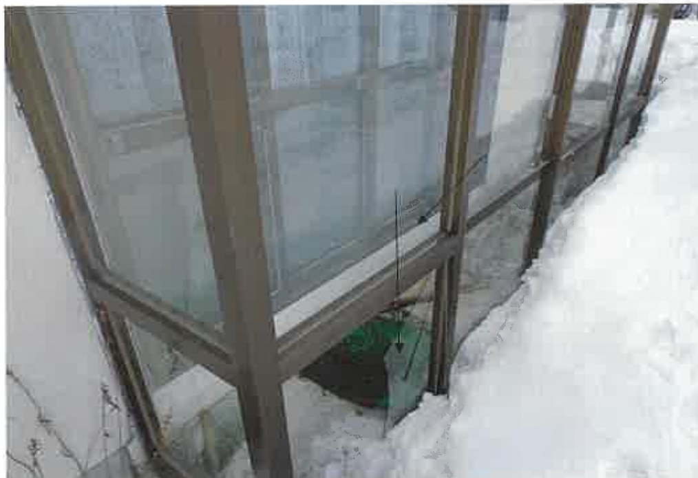
サンルーム ガラスの破損
