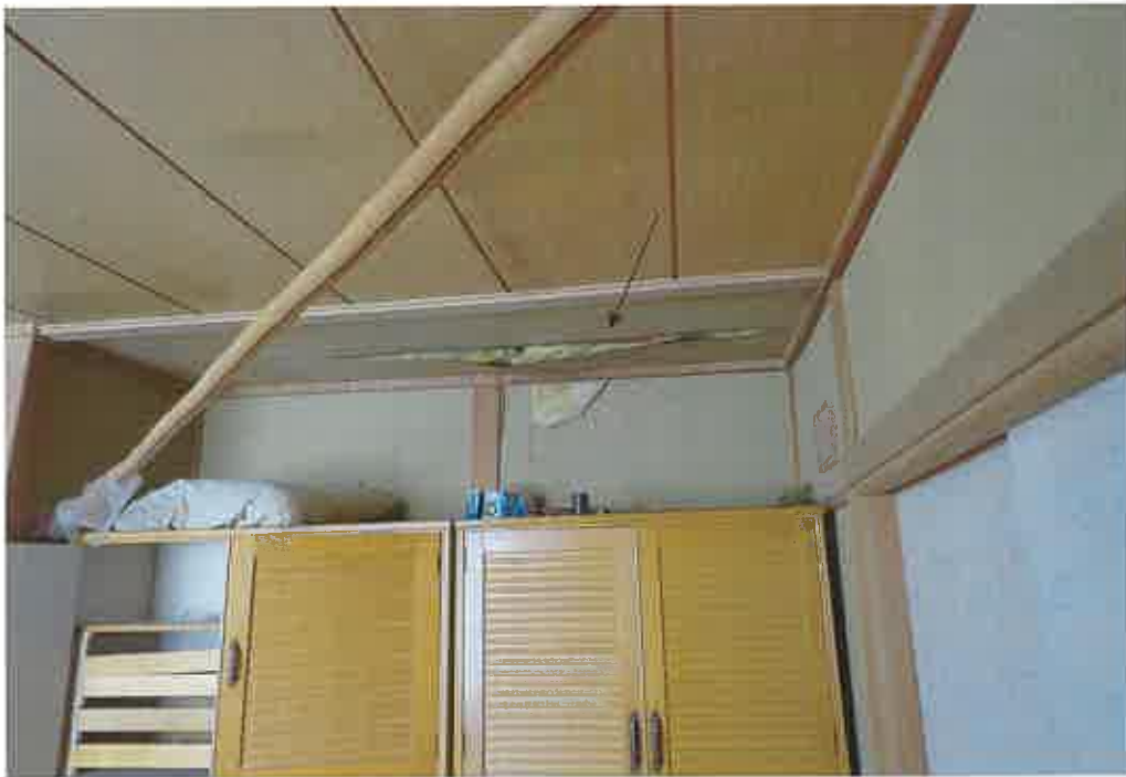
和室2 天井の損傷
