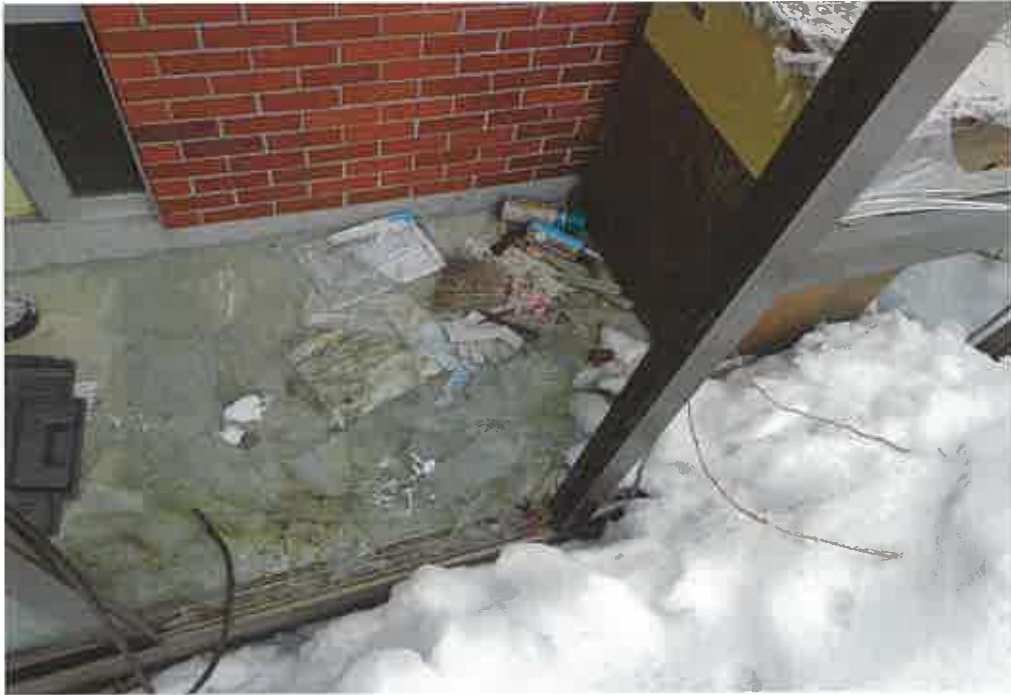
風除室 ガラスの破損
