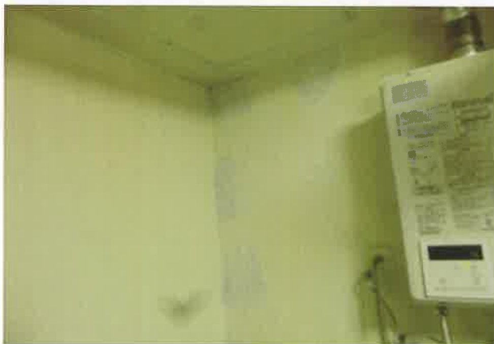
402号室 クロスの状況
