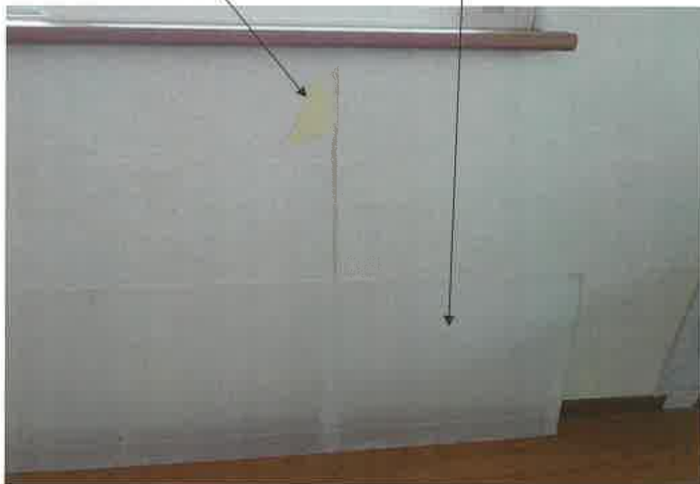
洋室3 壁紙の剥がれ 結露防止用のアクリルボード
