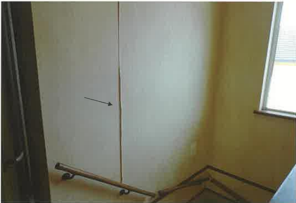
階段中腹の壁紙の剥がれ
