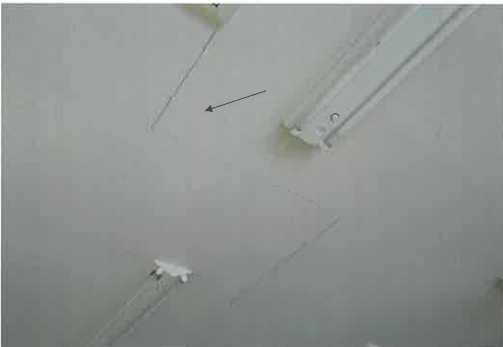
物件4 店舗部分 天井の亀裂
