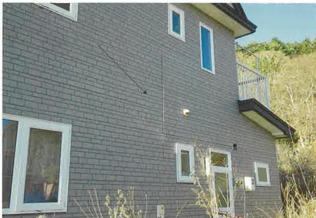
5 外壁（浮いている状況）
