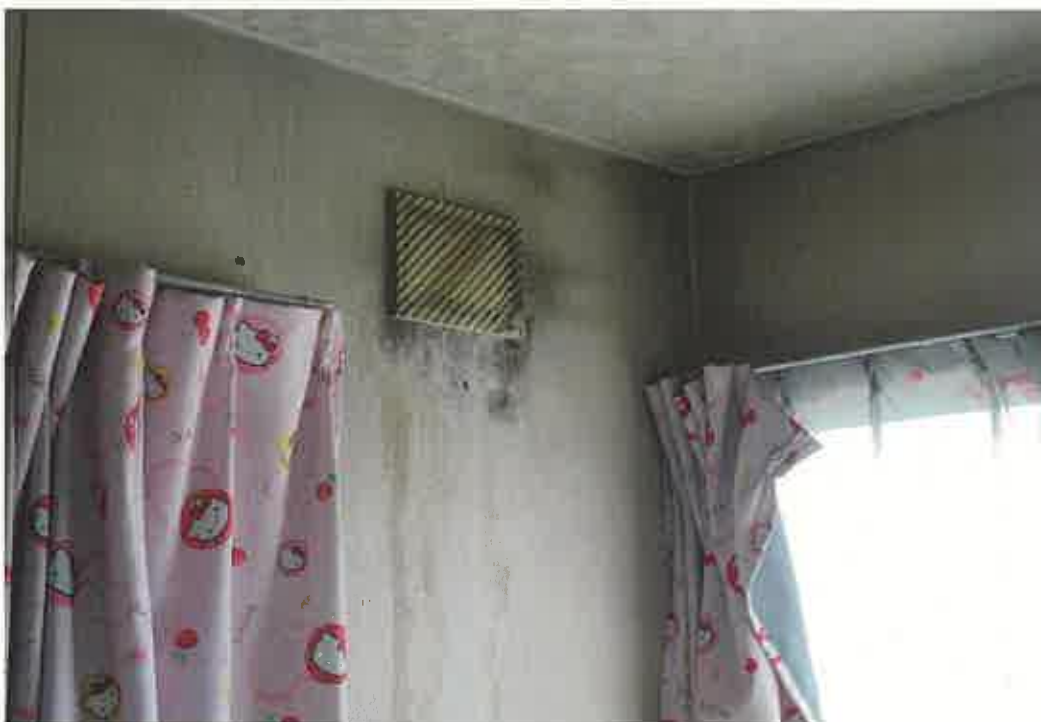
6 洋室1（汚損状況）
