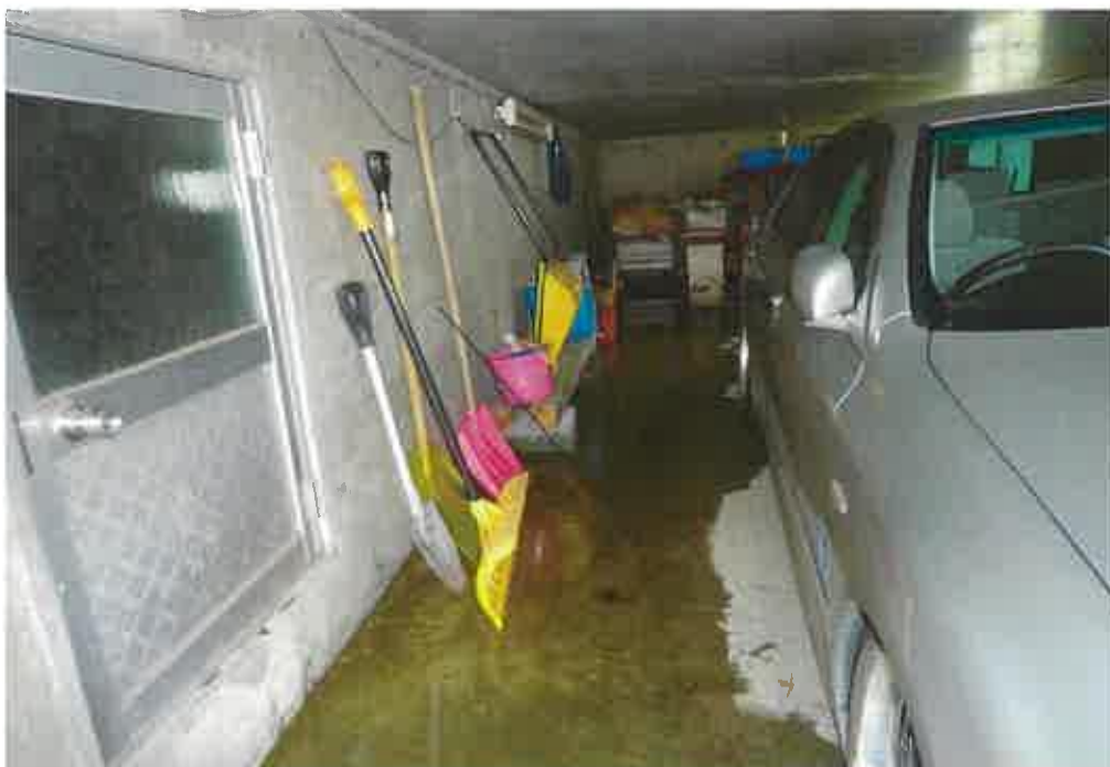
地下1階車庫の水漏れの状況
