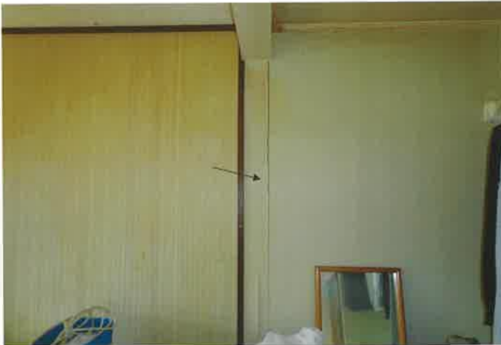
洋室1 内壁の亀裂
