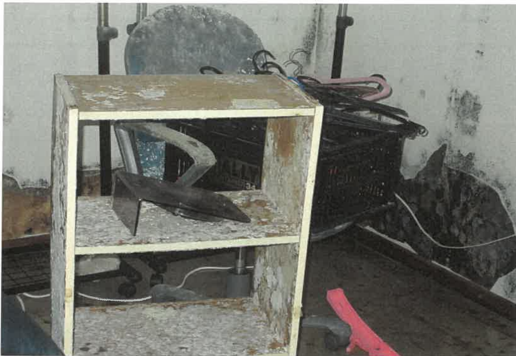
21 地下1階物置2② (汚損状況)
