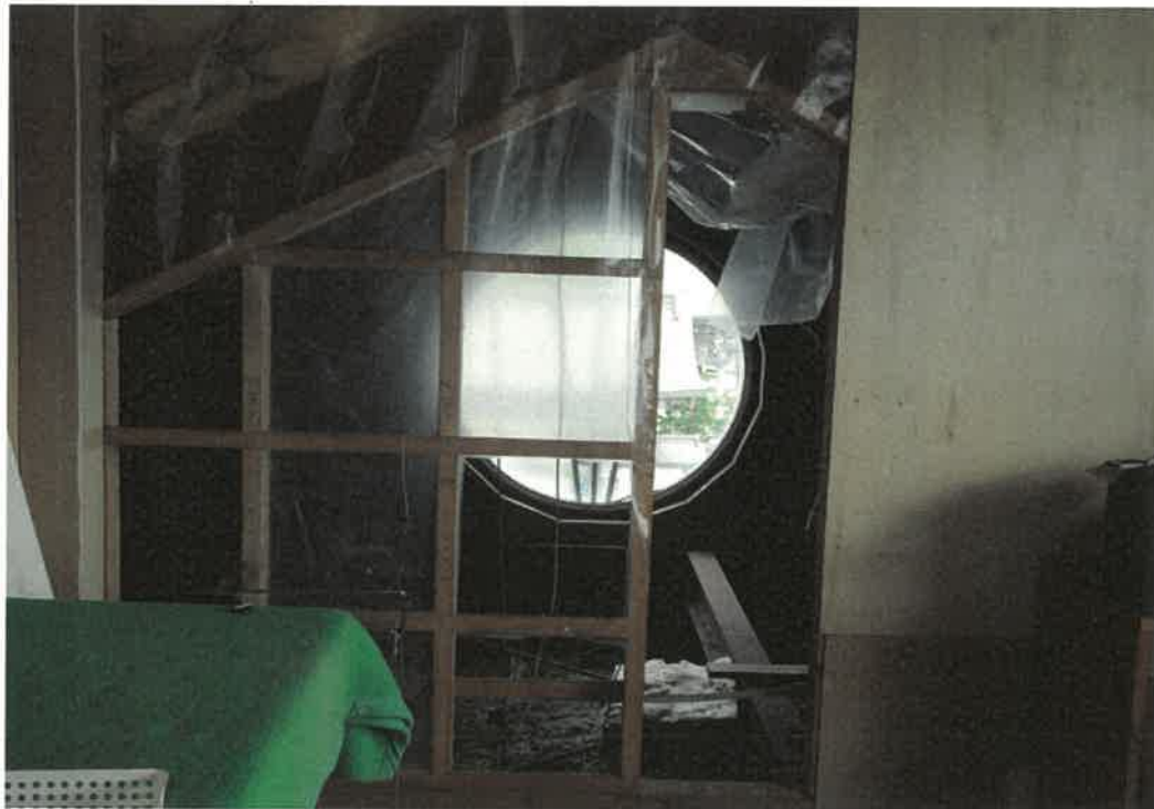
14 3階物置壁（損壊状況）
