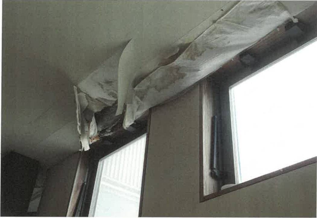
11 2階ホール天井（損壊状況）
