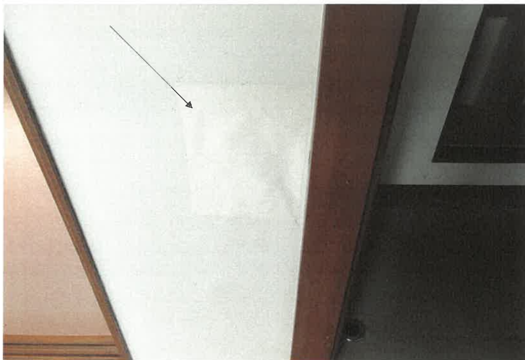
13 106号室居間の壁（補修痕状況）
