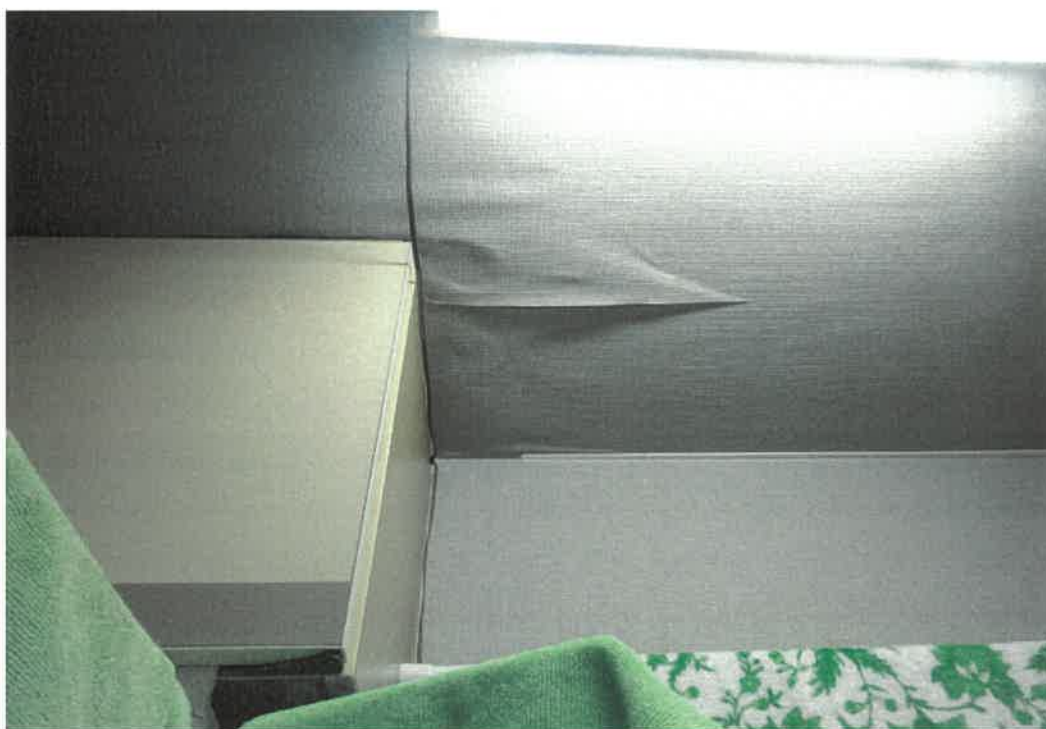
14 107号室台所の天井壁紙（剥離状況）
