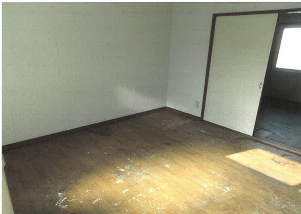
9 102号室居間の床（汚損状況）
