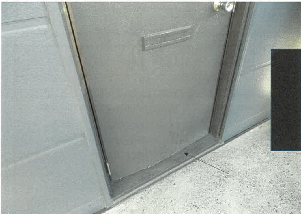
18 206号室玄関ドア外側部分（破損状況）
