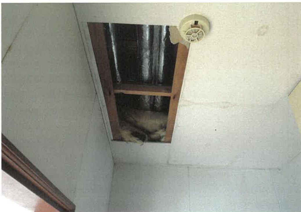
10 102号室台所の天井板（剥離状況）
