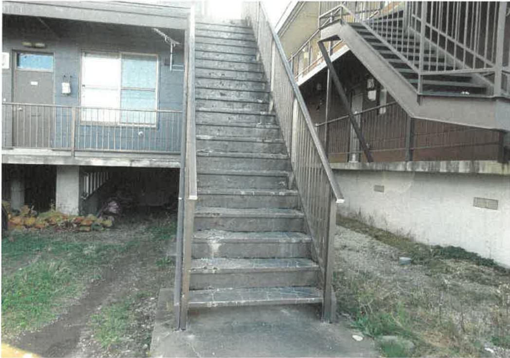
5 2階への階段（腐食、破損状況）
