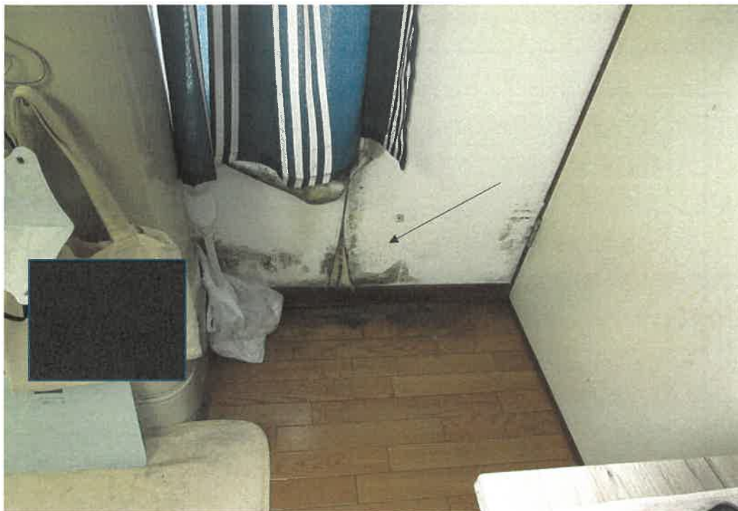
19 207号室居間の壁紙（汚損、剥離状況）
