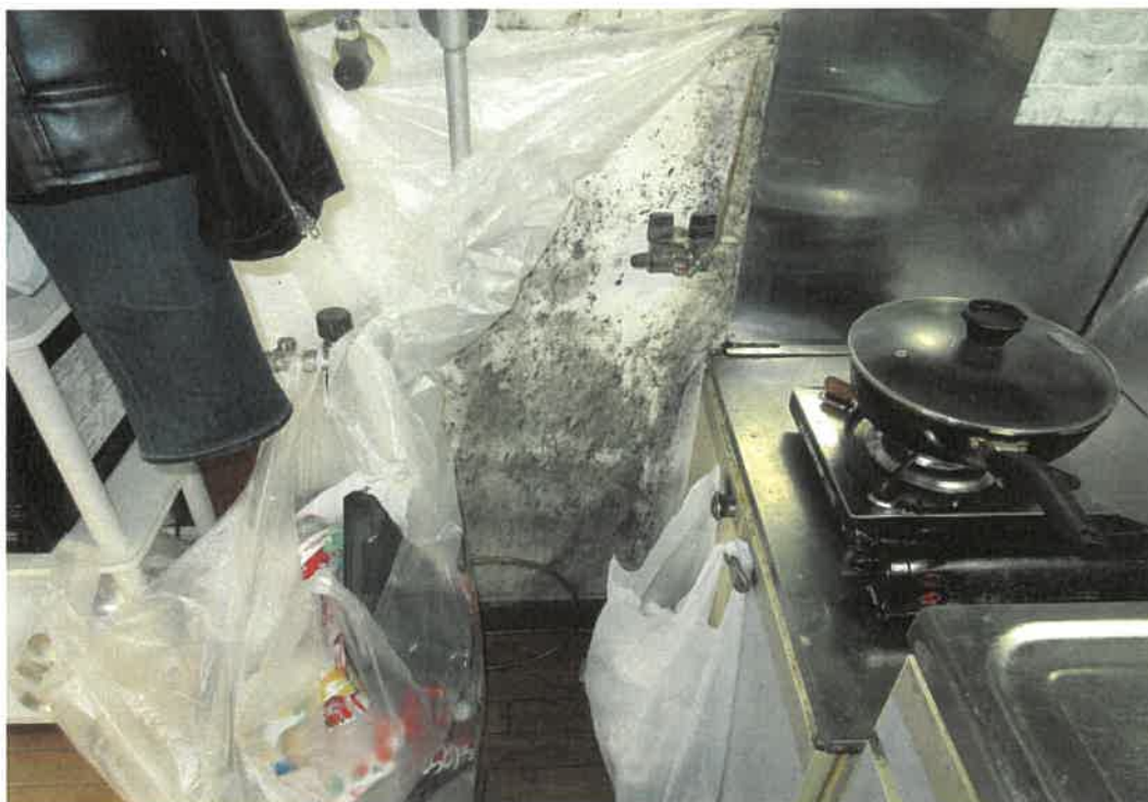
20 207号室台所の壁紙（汚損状況）
