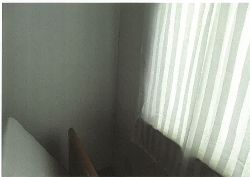
10 洋室4の角部分壁紙（汚損状況）
