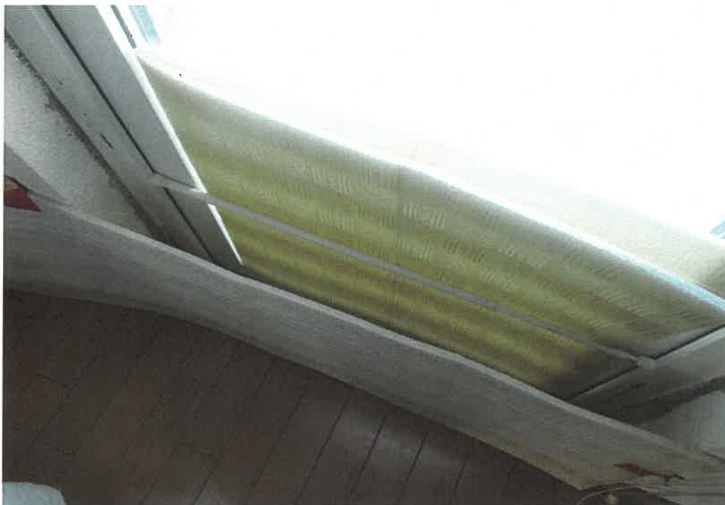
9 台所勝手口及びその付近（汚損状況）
