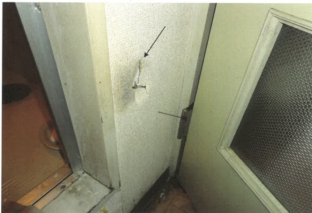
浴室のドア付近の内壁の穴
