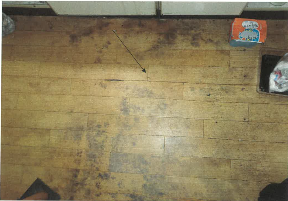
食堂・台所 流し台付近の床の汚損
