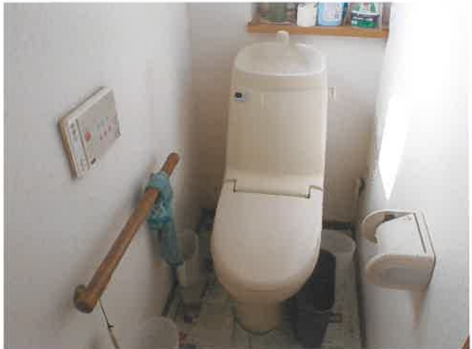
物件3 2階トイレ（使用不能）
