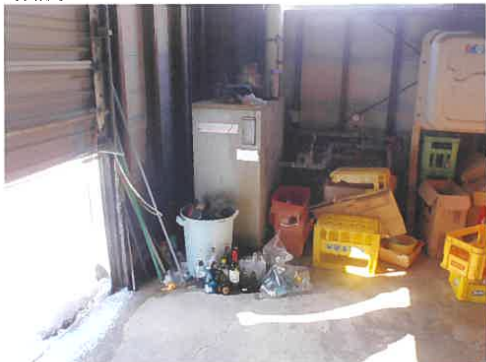
物件 2 車庫・物置に設置してある融雪ボイラー（稼働状況不明）
