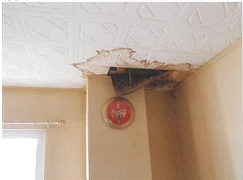
物件 2 2階洋室の天井部
