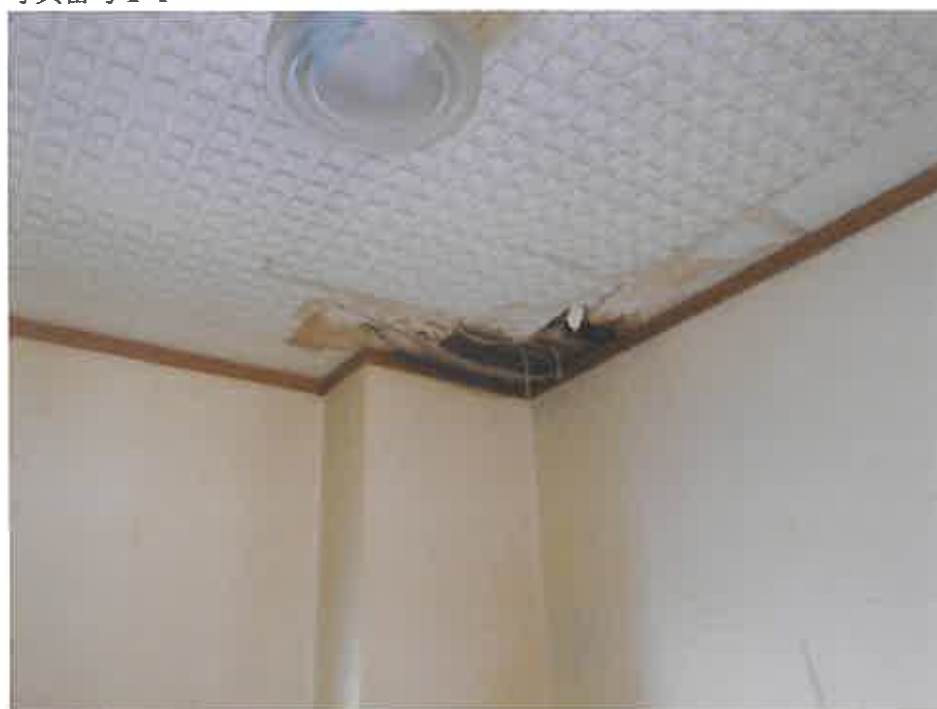
物件 2 2階和室（北東側）天井部分
