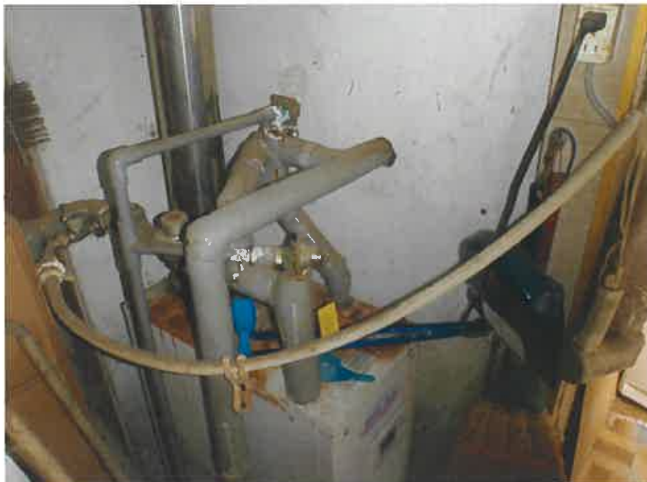
物件 3 ボイラー
