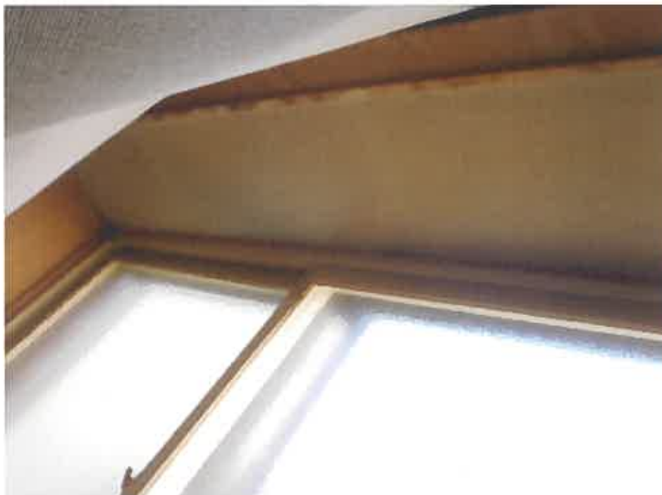
物件 3 1 階和室南西側窓（雨漏りが見られた）
