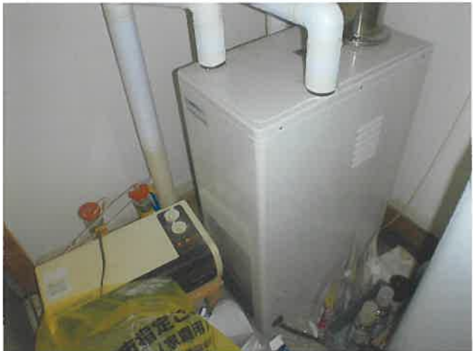
物件2 ボイラー
