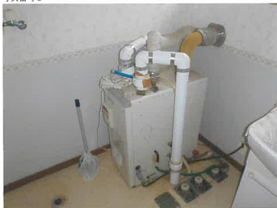
物件2 ボイラー
