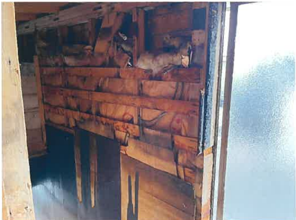
物件2 2階の火災の影響が残る壁面
