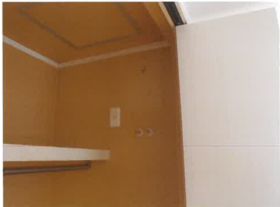
物件 2 2階洋室 (南東側) ※灯油給油ポンプ跡
