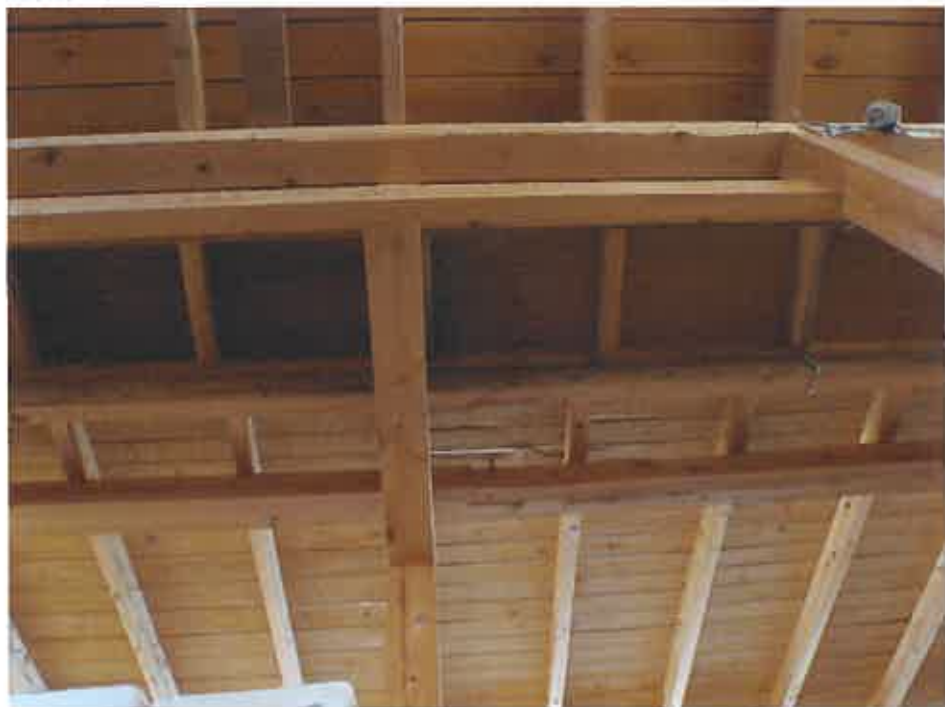
物件3 3階天井部分（無落雪の屋根の中央部分から水漏れの跡）
