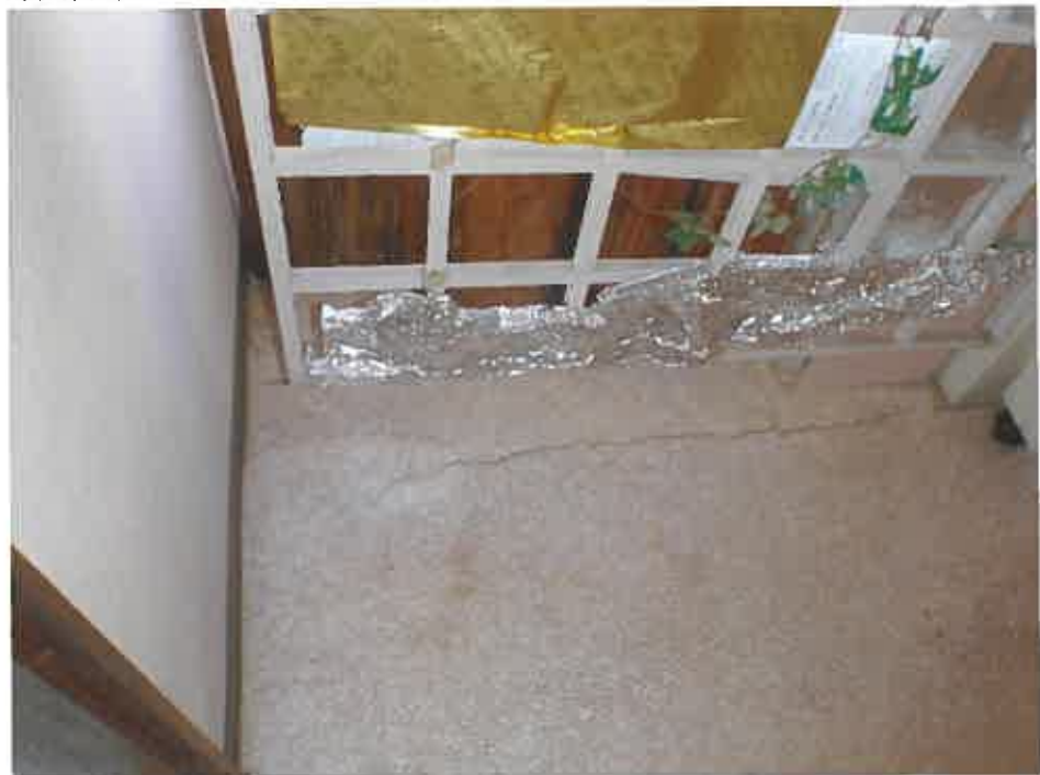
物件3 店舗入り口付近の床のひび割れ状況
