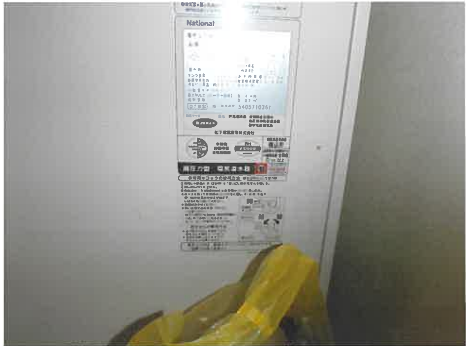
物件2 電気温水器
